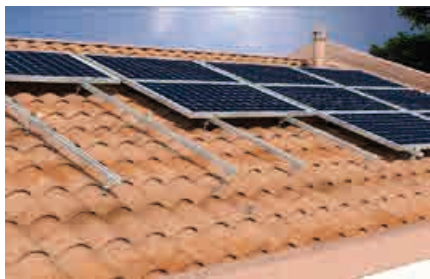
Estructura especial en cubierta coplanar
