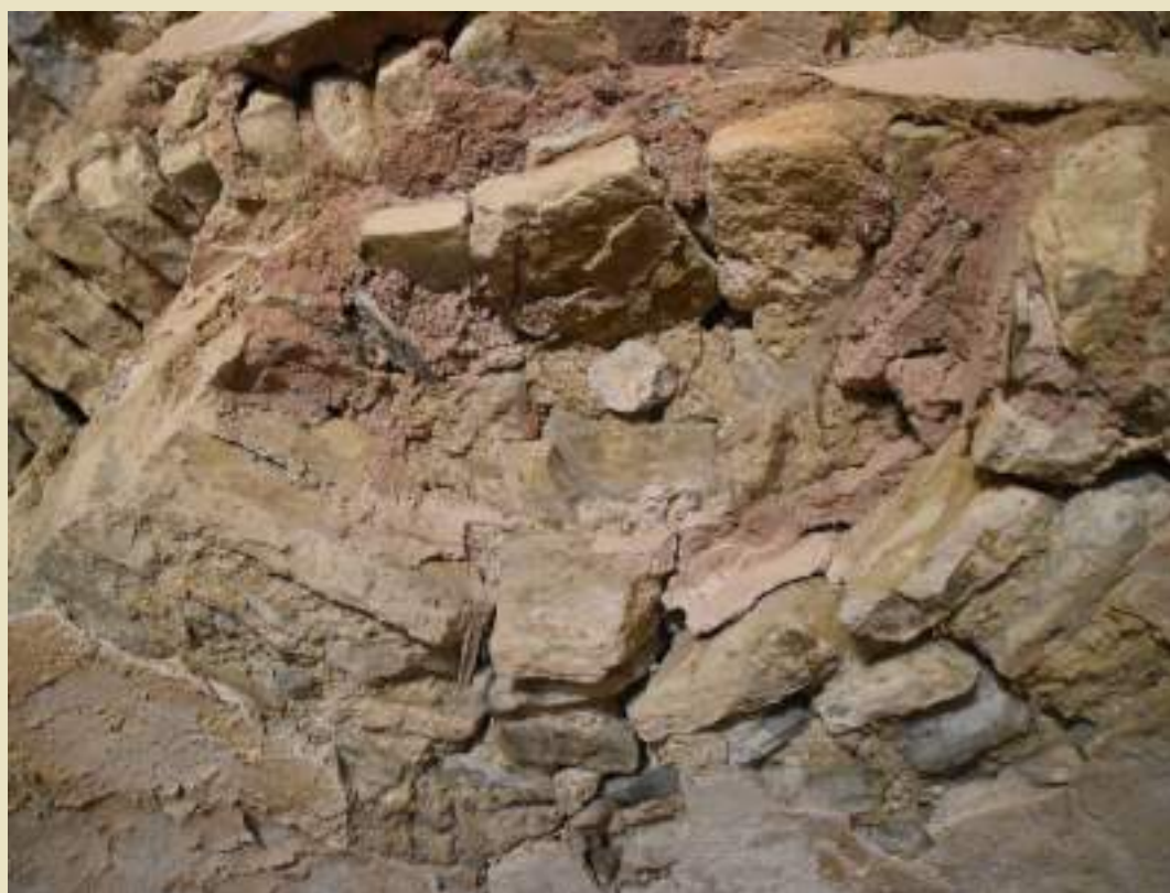
Fig. 30. Dues imatges de la coberta del presbiteri i el seu estat actual, a la imatge de sota es veu la seva pèrdua de secció que afecta perillosament la seva conservació. (Secció d'Arqueologia).
