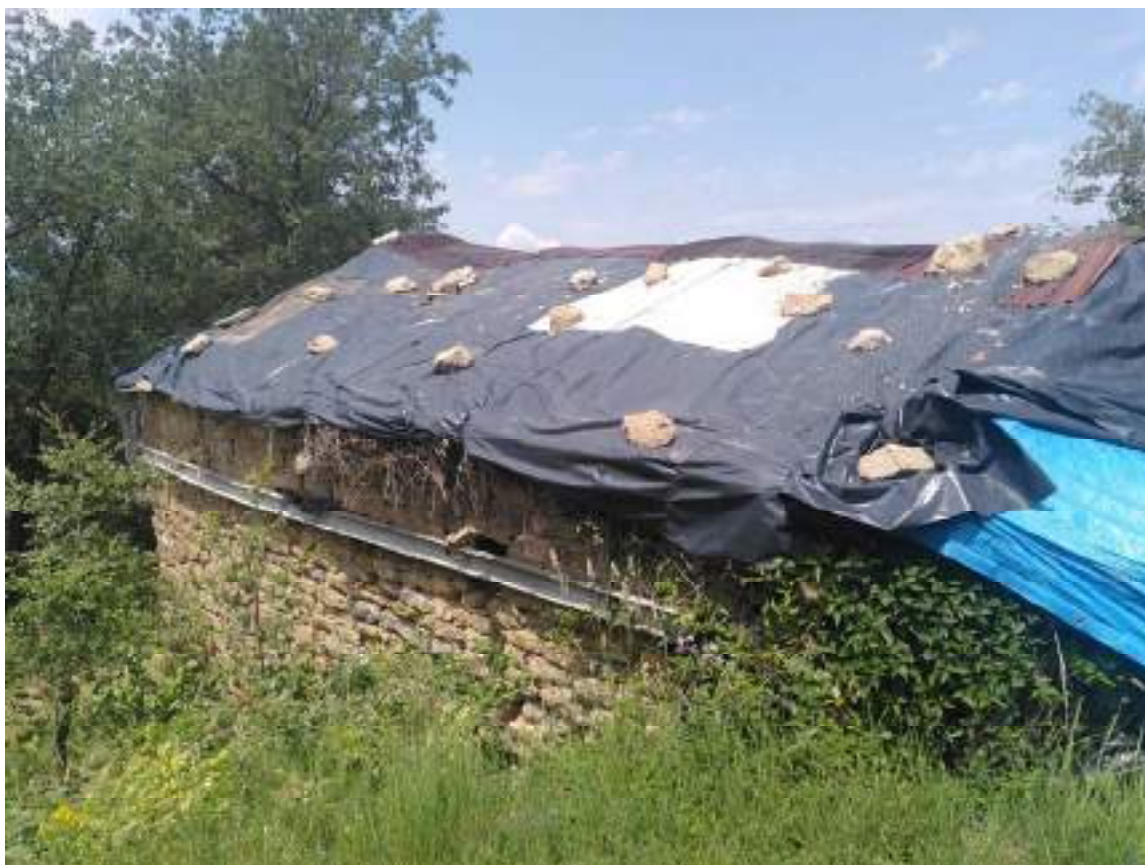
Imatge del sistema d'ancoratge dels tirants per la façana est (Fotografia del 4 de juliol de 2023)
