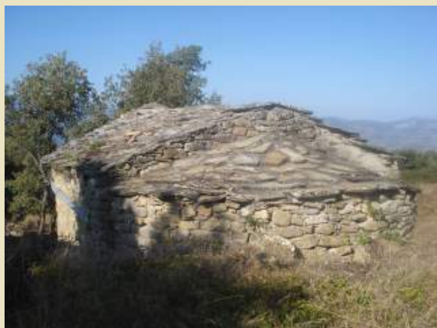
Fig. 12. Diferents imatges de la teulada al llarg del temps, dalt, al 1965 (J. Mir); mig, al 1977 (Gavin) i a sota el 2011 (Amics d'Aransís). A la imatge del 1965 es veu la reparació de teules del vessant nord i a les del 1967 de l'absis. A la de 2011 es veuen nítidament les lloses rejuntades i sense les teules.
