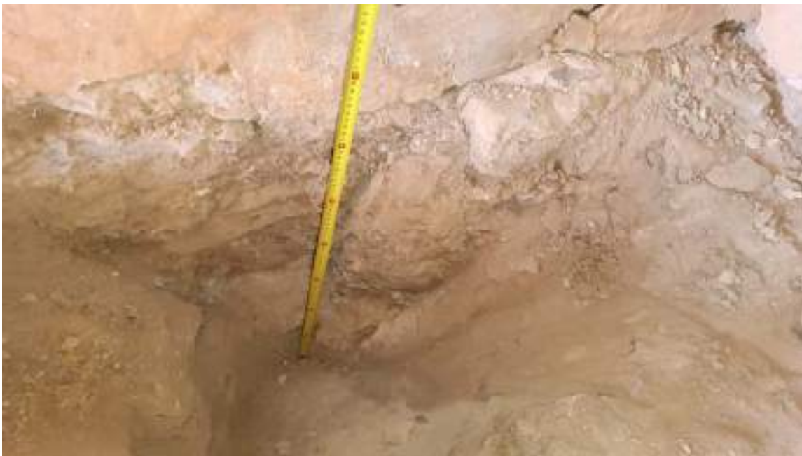
Cala 3 de la fonamentació en l'interior de l'ermita (Fotografia del 7 de febrer de 2024)
