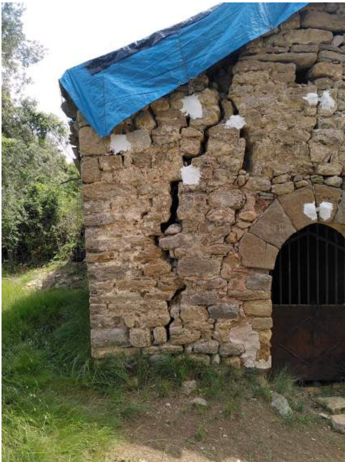
Esquerdas de la façana sud amb els testimonis de guix i vidre col·locats a l'agost de 2022 (Fotografia del 4 de juliol de 2023)
