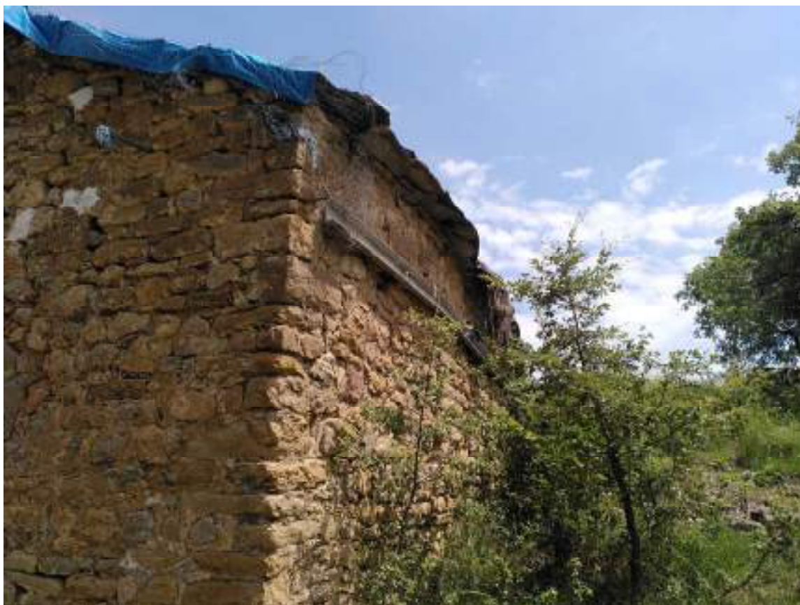
Imatge del sistema d'ancoratge dels tirants per la façana est (Fotografia del 4 de juliol de 2023)
