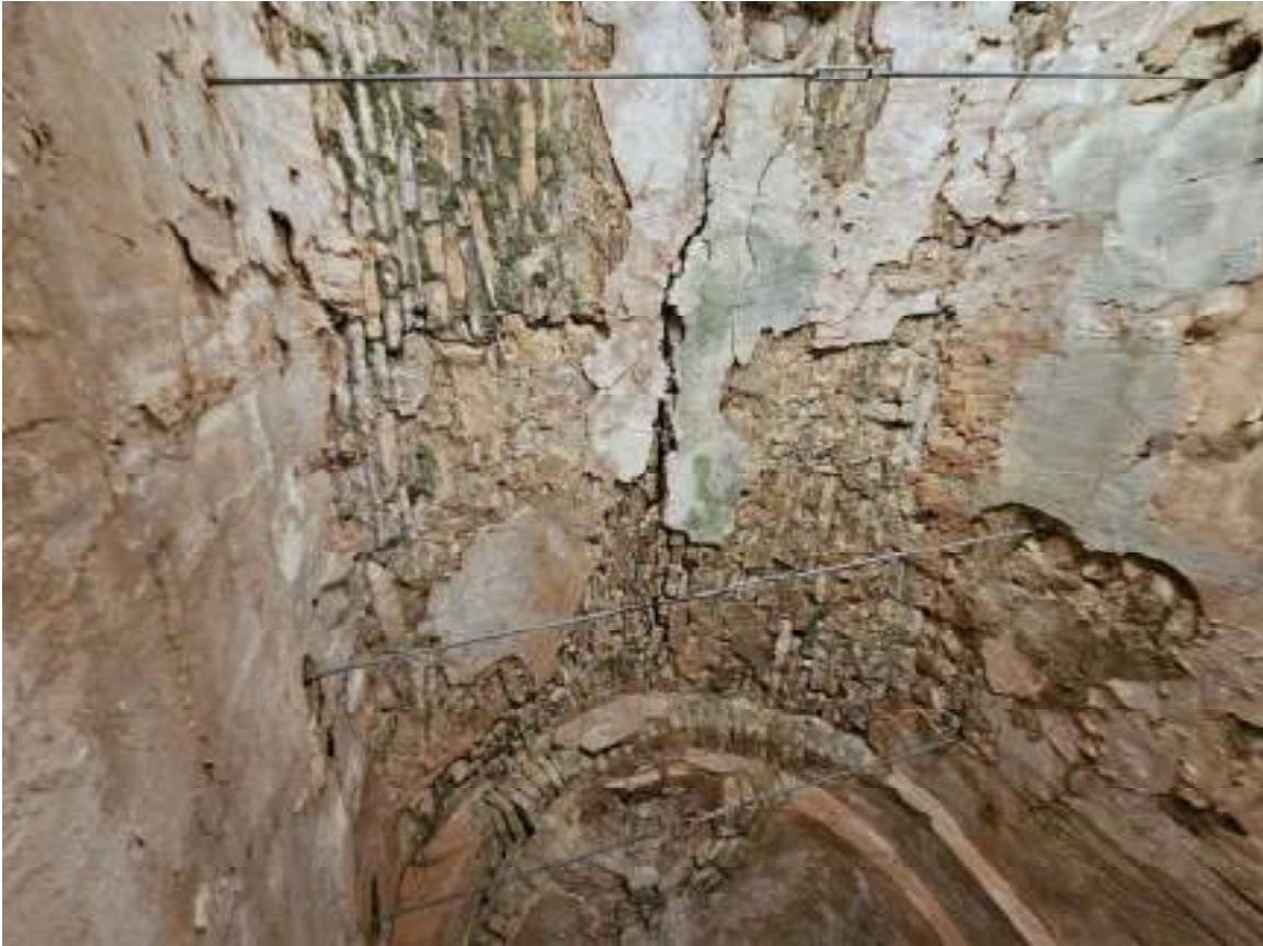
Patologies en la volta de canó de l'ermita (Fotografia del 29 de gener de 2024)
