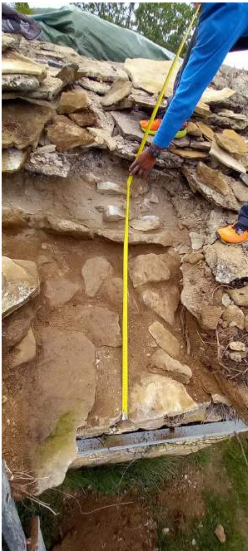
Cala en la coberta en l'entrega amb el mur de façana (Fotografia del 24 de maig de 2024)
