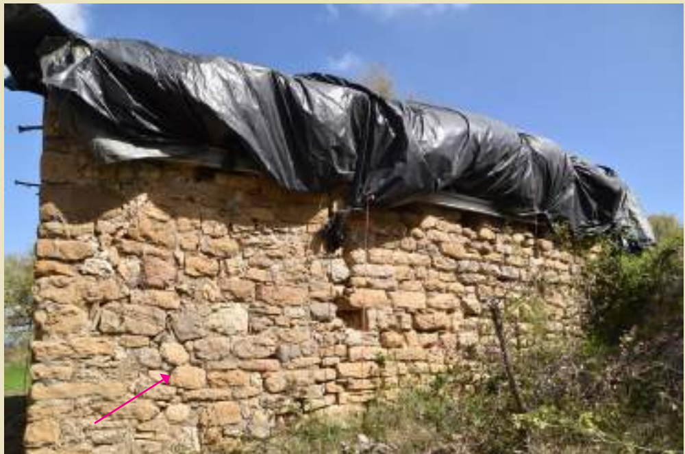
Fig. 13. Dalt vista dels forats del mur sud, amb l'esquerda al mig abans de la col·locació dels tensors (foto petita). A sota, detall de la cantonada sud-oest on es veu la modificació en el parament, punt on es troba l'actual fornícula, i que alguns autors la relacionen amb l'antiga porta d'accés a l'ermita.
