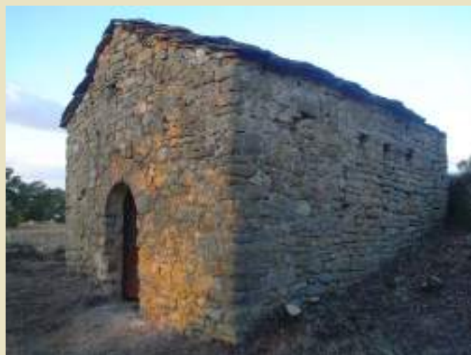
Fig. 14. Detall del punt de contacte entre els mur i la teulada. (Foto Amics d'Aransís).
