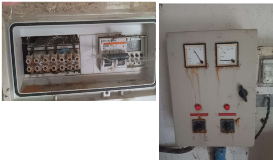
Il·lustració 4: Quadre elèctric amb presència d'oxid i cablejat deficient
