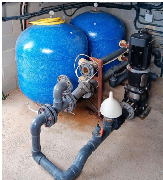
Il·lustració 3: Filtres existents on es comprova residus a l'interior del tub, elements malmesos
