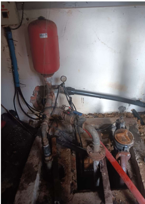
Il·lustració 1: Interior de la caseta del pou, sense proteccions i òxid en canonades
