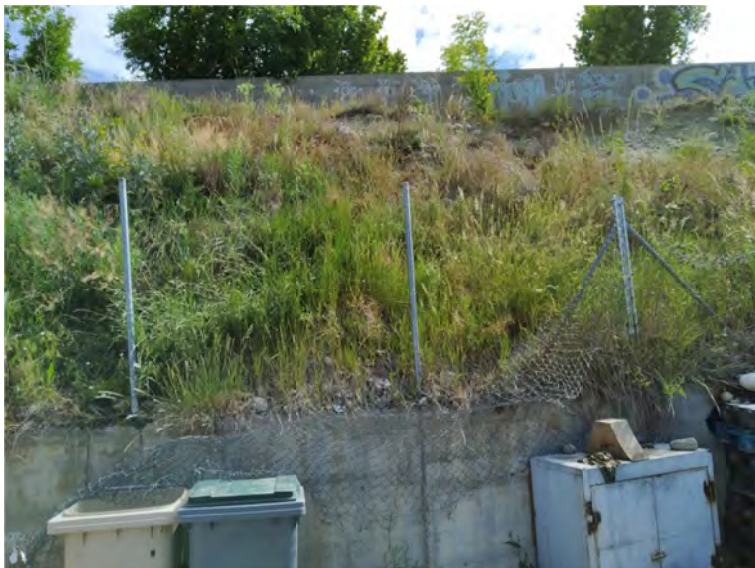
Fotografia 7. Vallat a límit Nord-Est deteriorat.
