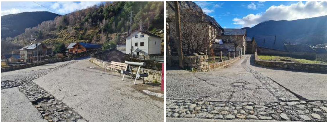
Imatge 2. Plaça del Molí: vista cap al Pont de la Capella i cal al Carrer de Subenuix. Veiem el paviment de formigó esquerdat i els camins de pedra desfets.
