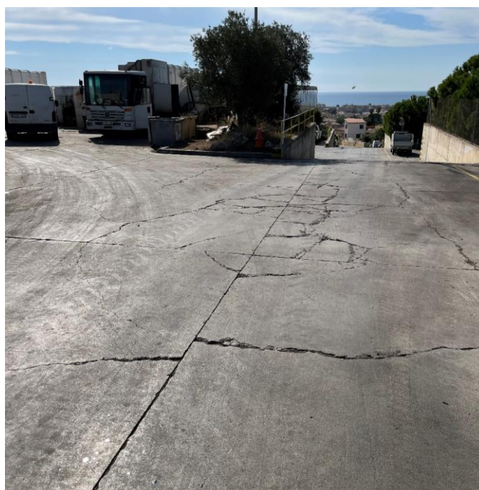
Detalle de grietas en pavimentos.
