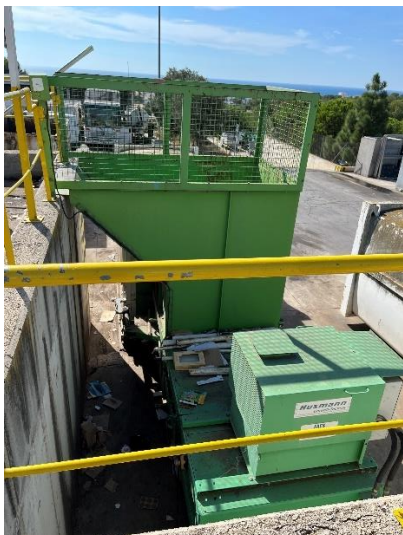
Detalle de desconches en pintura
