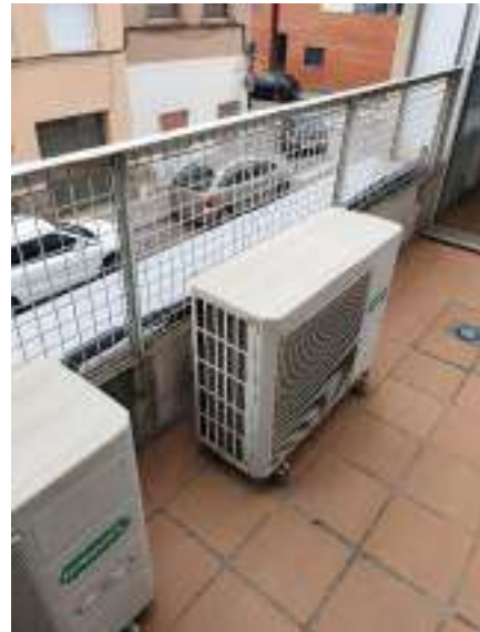
Espai per màquines
