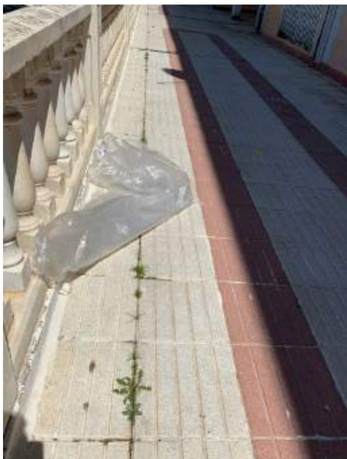
Vegetació i microorganismes a juntes de paviment de coberta
