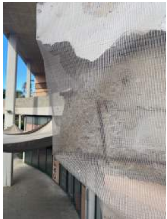
Cantells de forjat a rehabilitar
