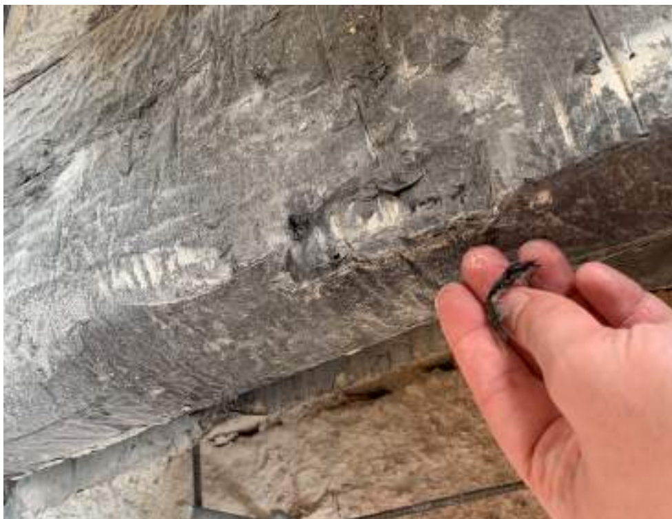
Estat de conservació tela asfàltica a trobada amb parament
