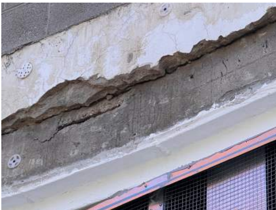
Cantells de forjat a rehabilitar
