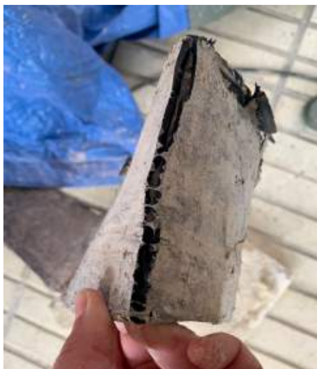
Estat de conservació tela asfàltica
