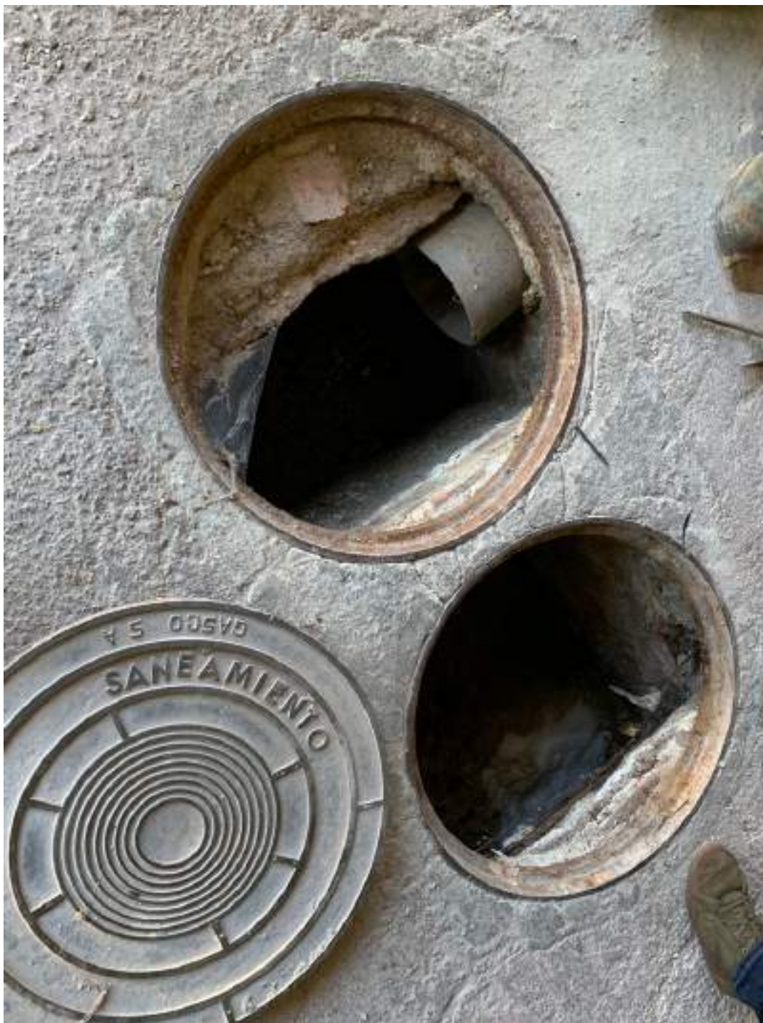
Arqueta sifònica inspeccionada
