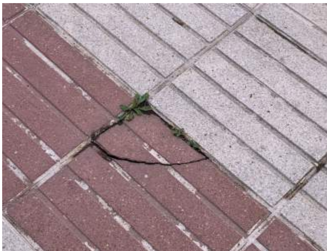
Trencament a peça de paviment de coberta
