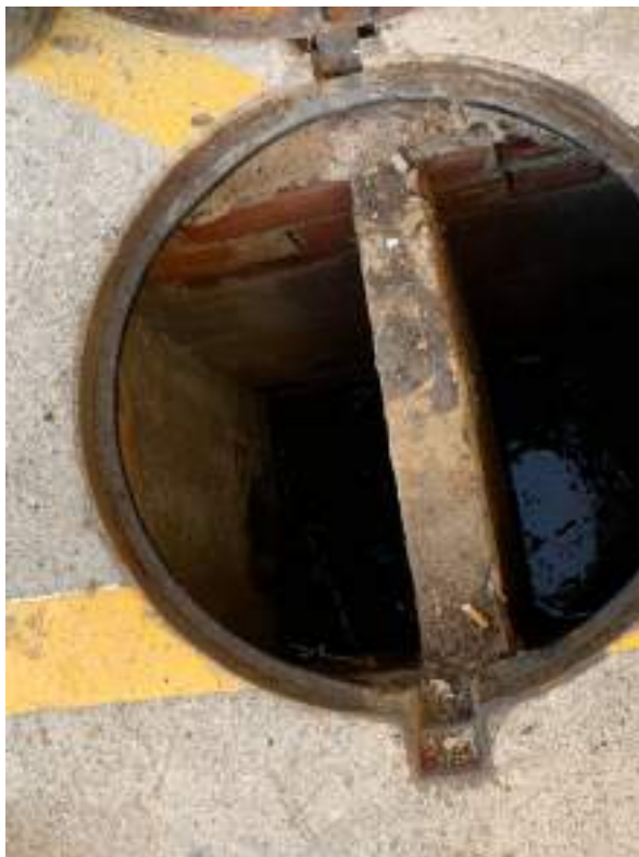
Arqueta sifònica inspeccionada
