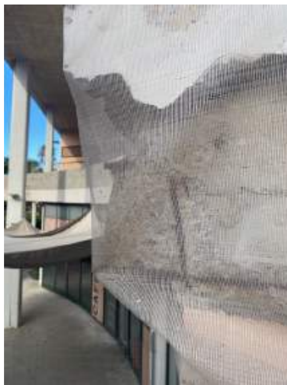
Cantells de forjat a rehabilitar
