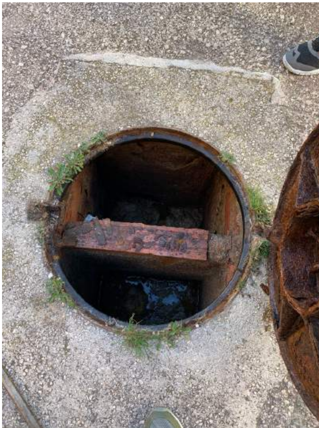
Arqueta sifònica inspeccionada
