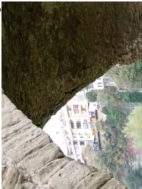
Esquerda intradós, separació entre dovelles de l'arc i l'intradós – Foto 23.11.15
