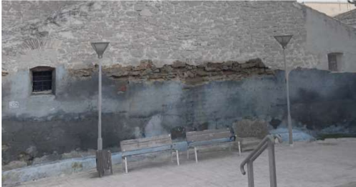
Fot. 1 Imatge de l'erosió en murs de maçoneria de façana
