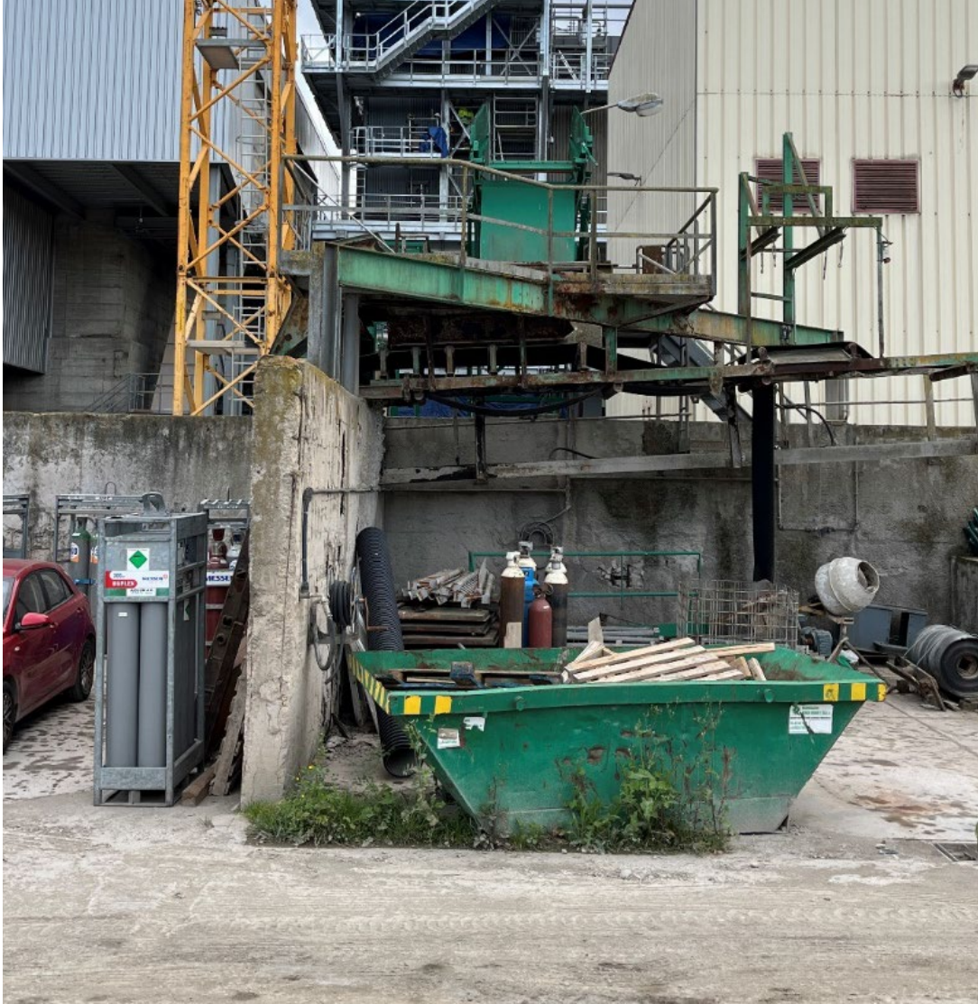
Imatge 4 – Vista dels equips de crivellat i estructura auxiliar
