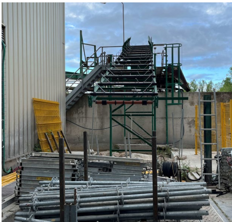
Imatge 2 – Vista dels suports existents instal·lats del sistema d'extracció d'escòries
