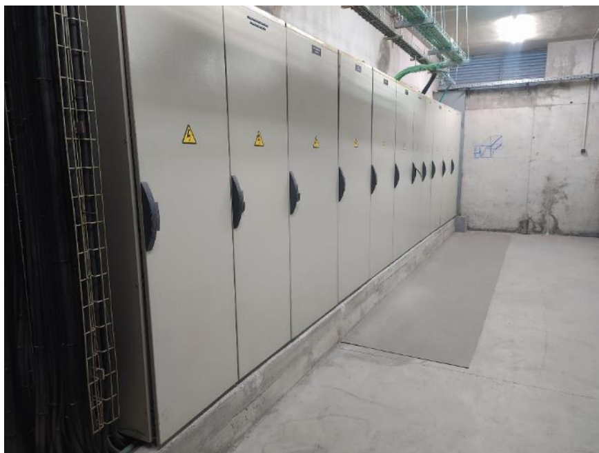
Imatge 9. Sala Quadre general de l'edifici nou en planta -1
