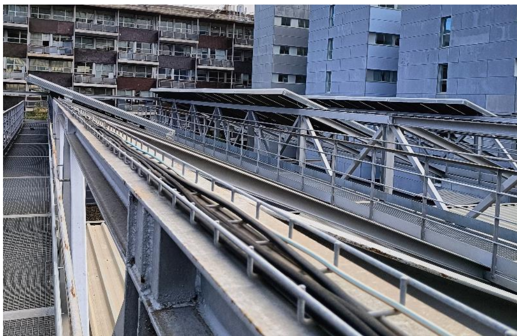
Safates de reixa existents per al cablejat DC en les que s'haurà d'instal·lar tapa
