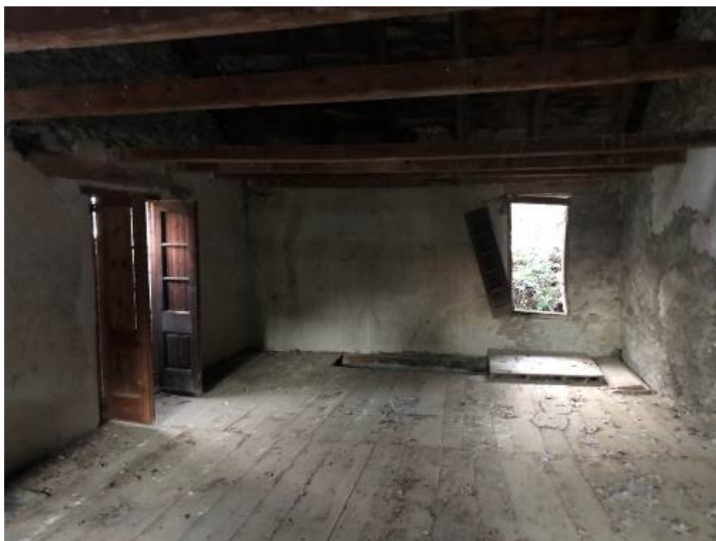
Planta sota coberta on s'observen les fusteries exteriors força deteriorades.
