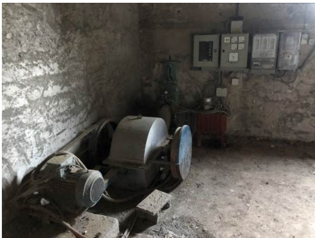
Maquinari antiga central hidraulica
