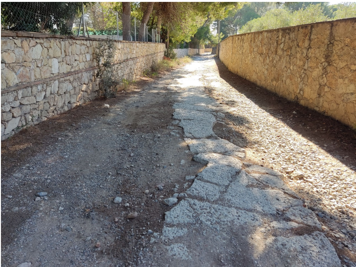
FOTO 10.- TRAM 2.1. PK 0+160. Restes dels pedaços fets amb formigó.
