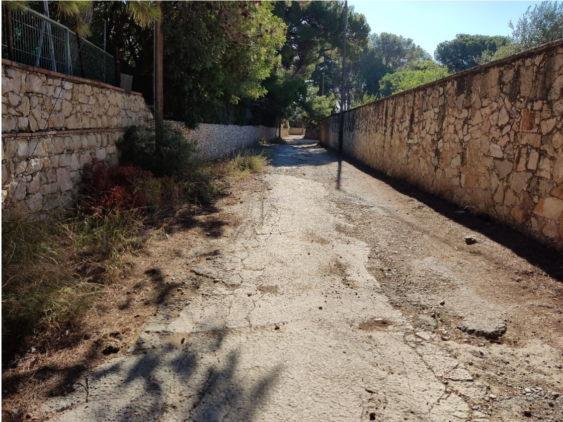
FOTO 9.- TRAM 2.1. PK 0+130. Restes de l'antic paviment de regs asfàltics.
