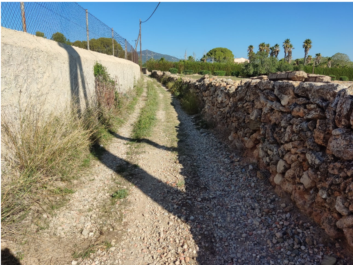
FOTO 12.- TRAM 2.2. PK 0+060. Camí entre marges. Material granular solt.
