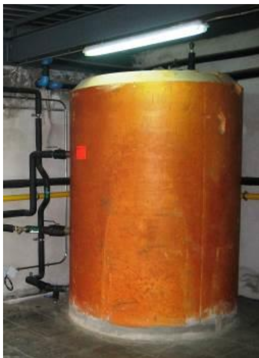
Foto 5. Dipòsit acumulador solar ACS 3000 l.
