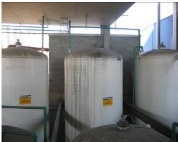
Foto 3. Dipòsits acumuladors PCI
