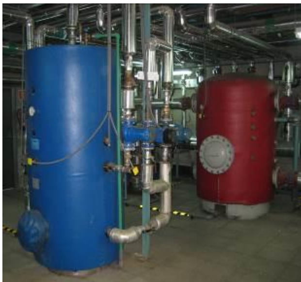
Foto 1. Dipòsits en sala calderes
