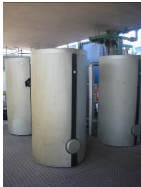
Foto 2. Dipòsits acumuladors 4 ud. VITOCCELL 1000 l.
