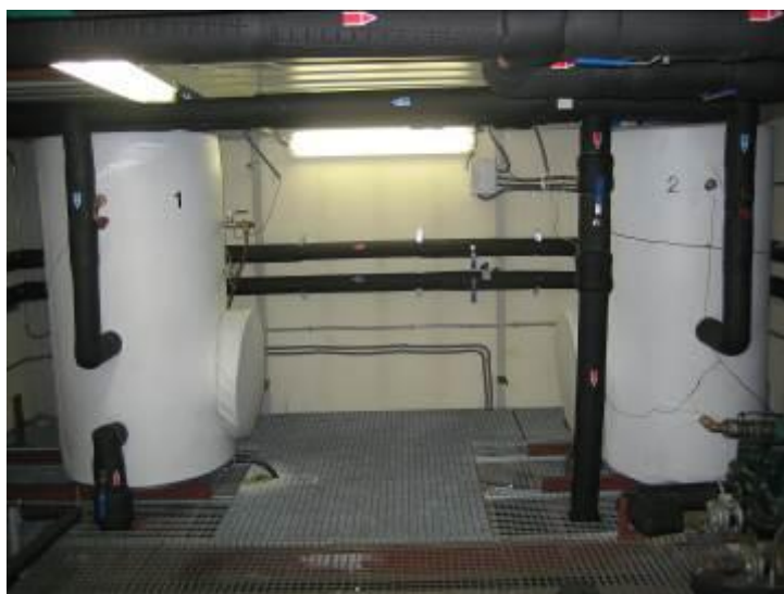
Foto 8. Dipòsits acumuladors d'ACS
