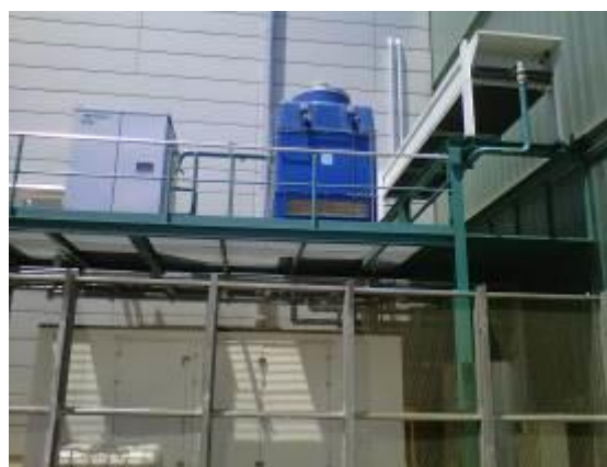
Foto 6. Torre de refrigeración. Vista 2
