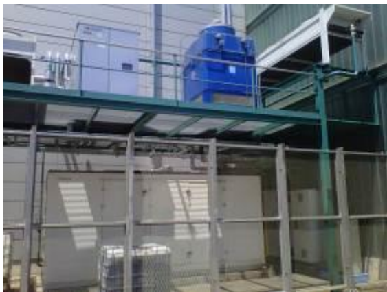
Foto 5. Torre de refrigeració. Vista 1
