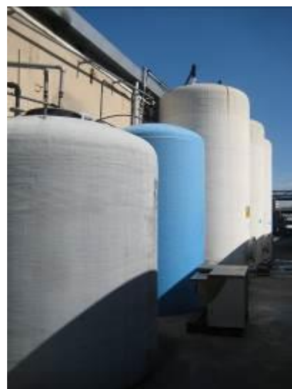
Foto 6. Dipòsits instal·lació ANPR
