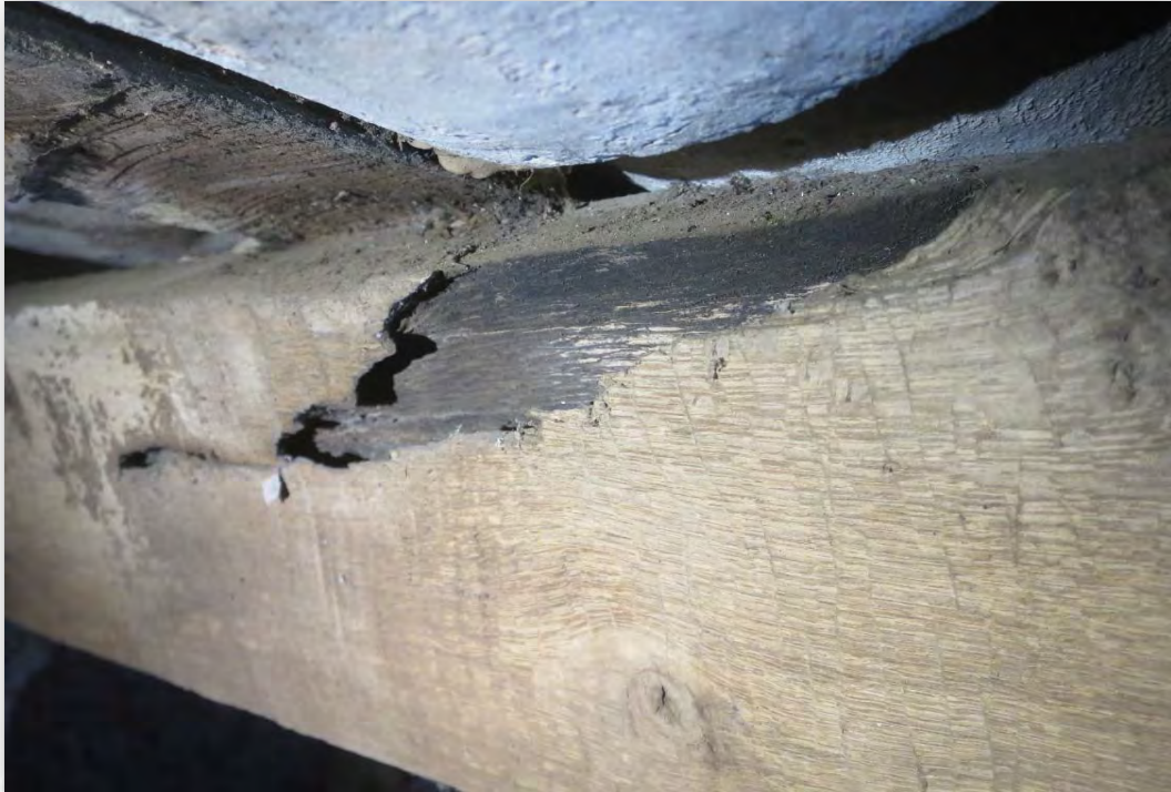
Sostre de la planta coberta (PC), església. Element PCB6. Imatge 148 Irregularitat
