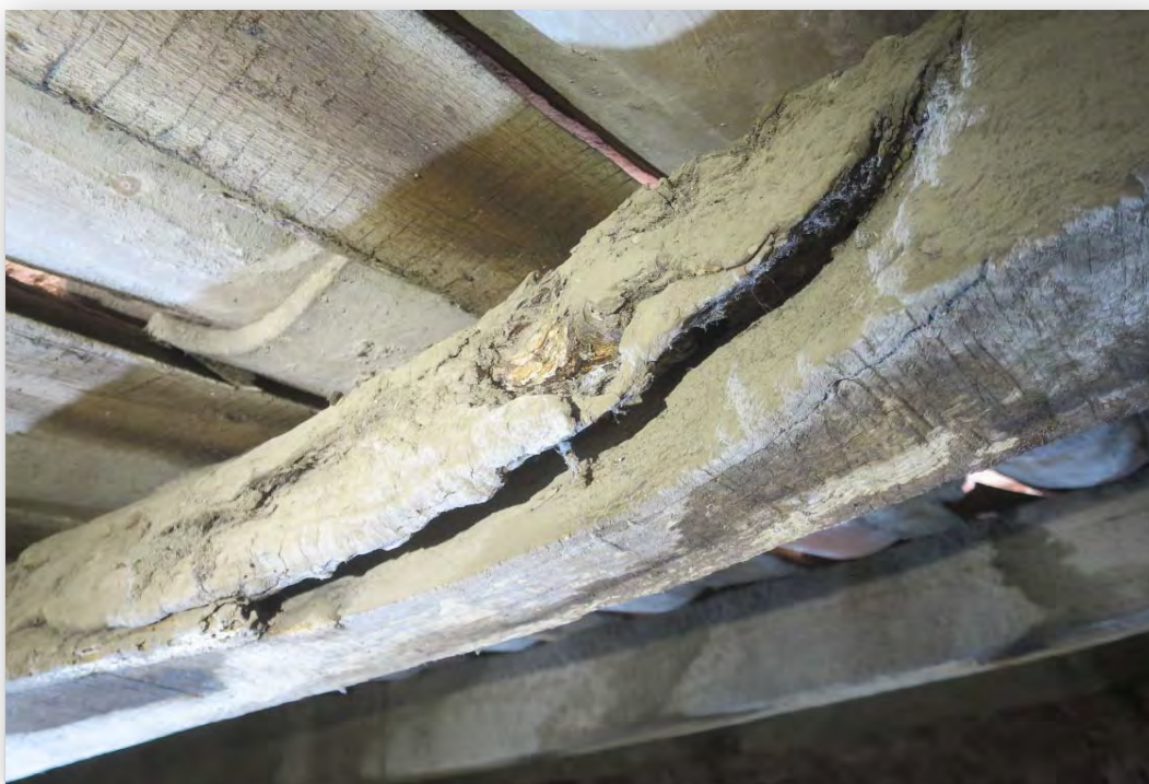
Sostre de la planta coberta (PC), església. Element PCC4. Imatge 142 Irregularitat
