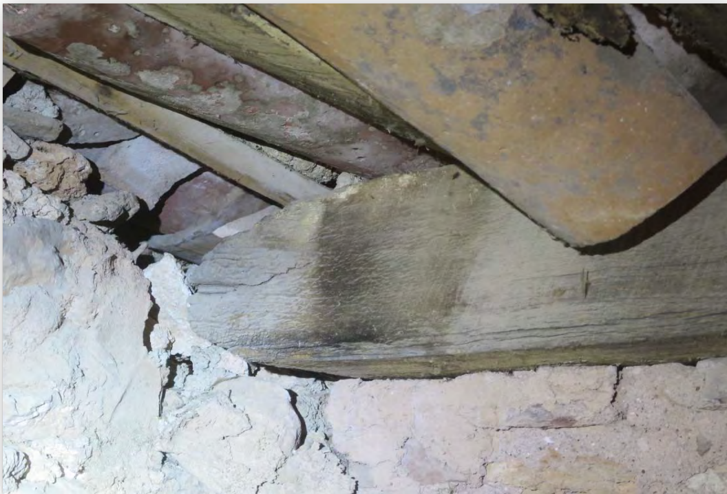
Sostre de la planta coberta (PC), església. Element PCB20. Imatge 137 Degradació causada per fongs de podriment en l'extrem est
