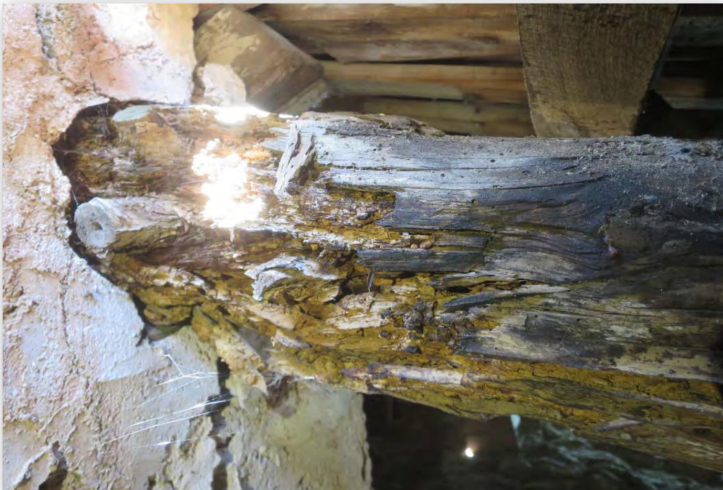
Sostre de la planta coberta (PC), església. Element PCA18 (jàssera). Imatge 135 Degradació causada per corcs i fongs de podriment
