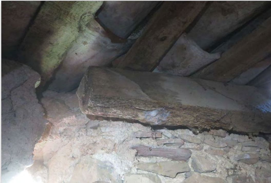
Sostre de la planta coberta (PC), església. Element PCB1.1. Imatge 145 Manca de recolzament en l'extrem oest
