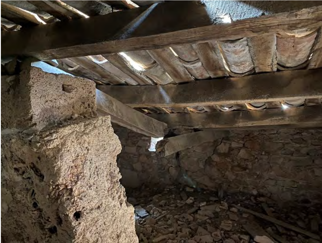
Intradós de la coberta, estat de degradació. Font B. Onecha, 2023
