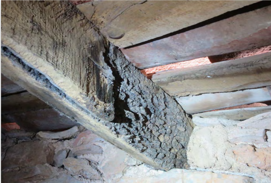
Sostre de la planta coberta (PC), església. Element PCB18. Imatge 138 Degradació causada per fongs de podriment en l'extrem est
