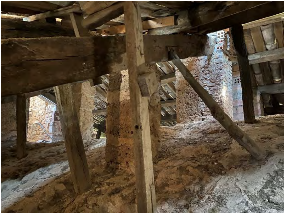
Intradós de la coberta, puntals d'obra de fàbrica i de fusta. Font B. Onecha, 2023
