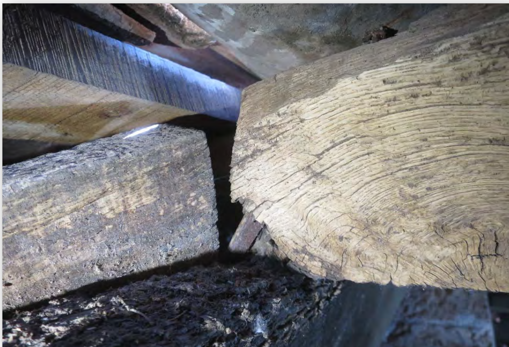
Sostre de la planta coberta (PC), església. Element PCC4. Imatge 143 Recolzament deficient en l'extrem est
