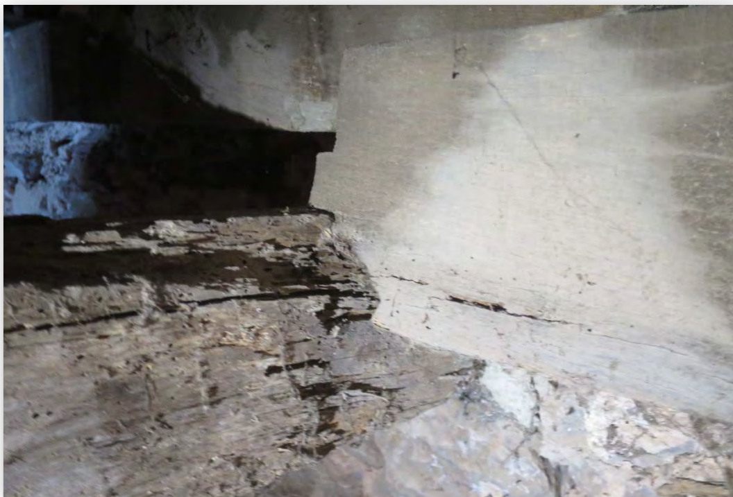
Sostre de la planta coberta (PC), església. Element PCB1.2. Imatge 147 Manca de recolzament en l'extrem oest
