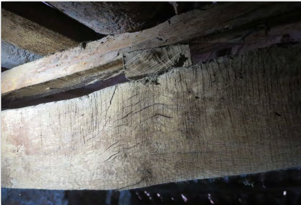
Sostre de la planta coberta (PC), església. Element PCA7. Imatge 132 Trencament de les fibres Fletxa significativa aparent
