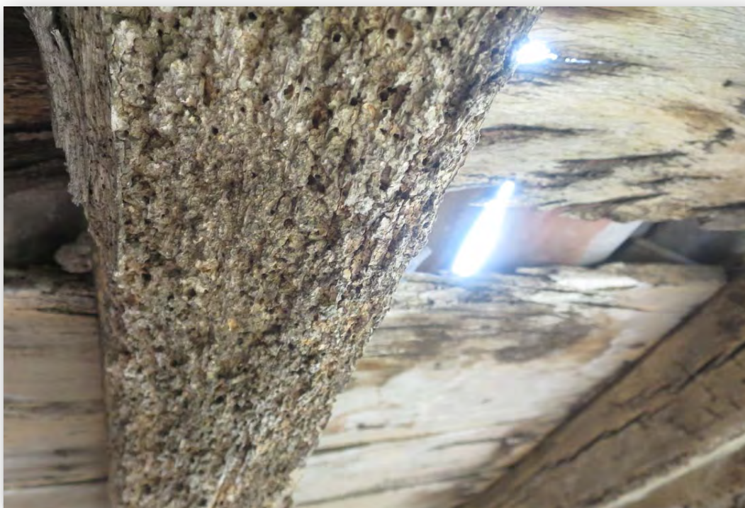
Sostre de la planta coberta (PC), campanar. Element PCE2.2. Imatge 151 Degradació causada per corcs i tèrmits aeris
