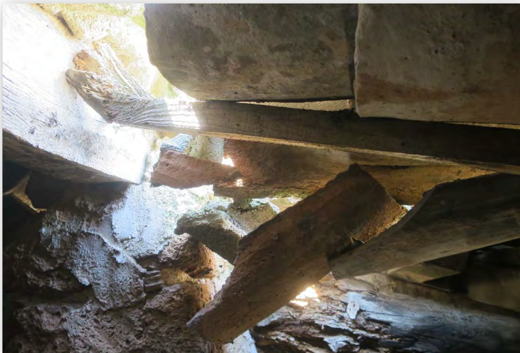
Sostre de la planta coberta (PC), església. Element PCA10. Imatge 130 Teulada en mal estat
