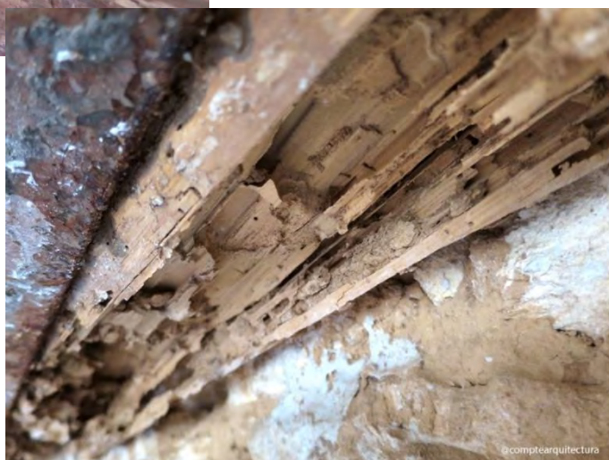
Degradació de la fusta causada pels tèrmits subterranis
