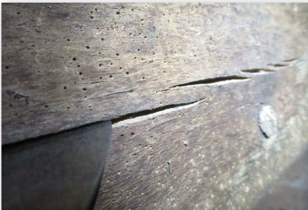
Sostre de la planta coberta (PC), església. Element PCB27 (jàssera). Imatge 141 Clivelles significatives en el pla horitzontal
