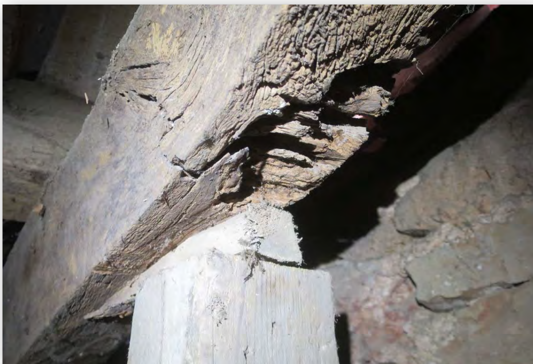
Sostre de la planta coberta (PC), església. Element PCB30 (jässera). Imatge 139 Trencament de les fibres Apuntament de fusta
