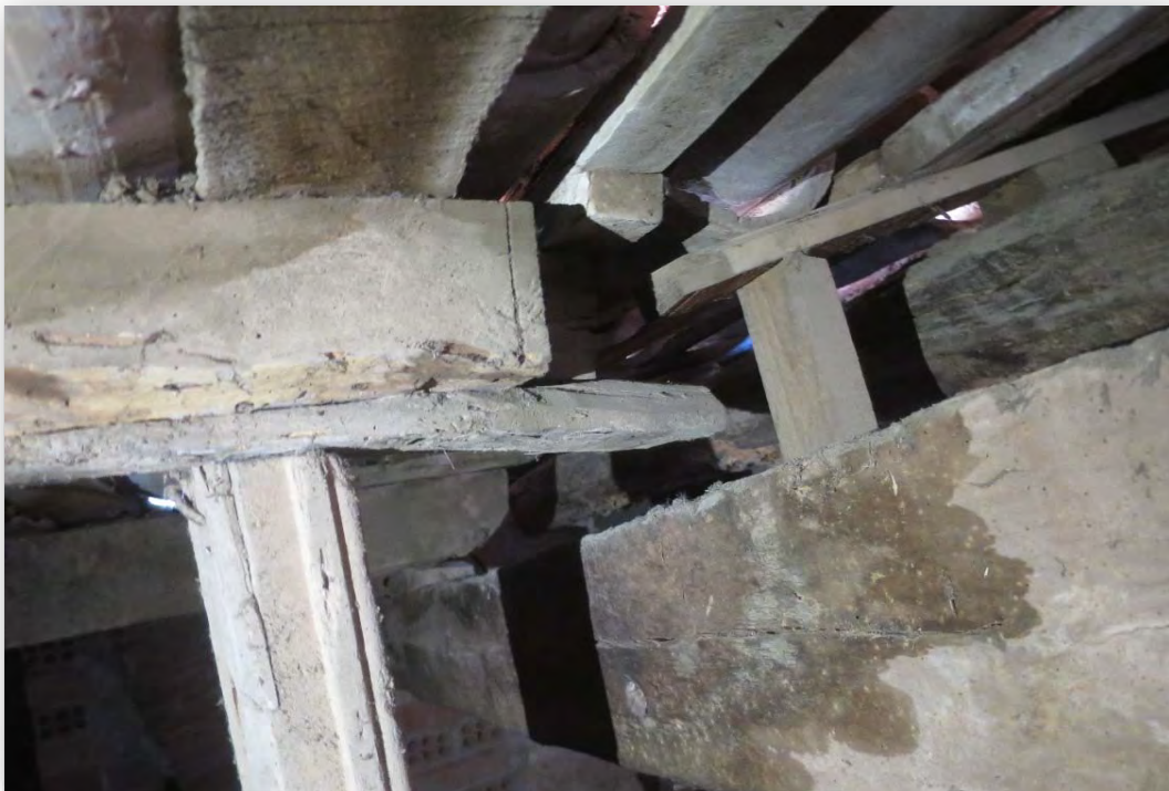
Sostre de la planta coberta (PC), església. Element PCB13. Imatge 140 Manca de recolzament en l'extrem oest Apuntament de fusta
