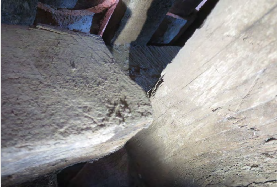
Sostre de la planta coberta (PC), església. Element PCA11. Imatge 134 Manca de recolzament en l'extrem oest
