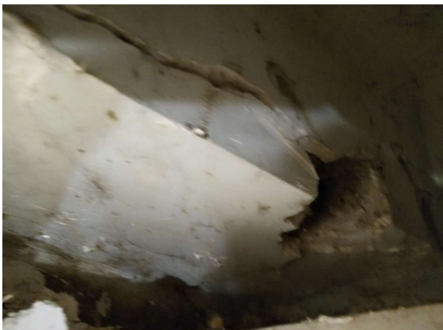
Jàssera molt deteriorada en habitatge escala “A”
