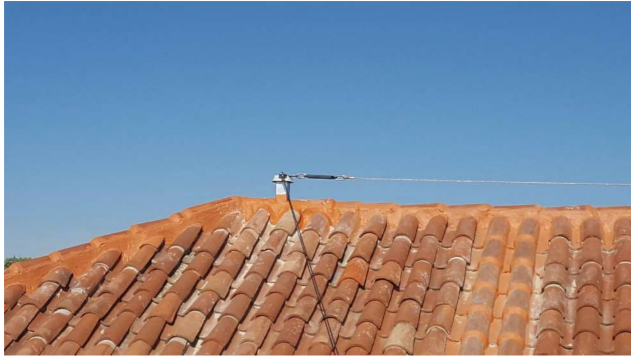
LINIA DE VIDA EN COBERTA INCLINADA
