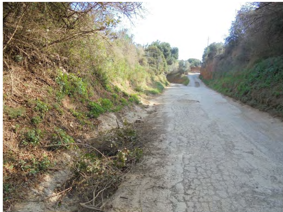
Cuneta formigonada per on circula les aigües del torrent innominat que circula per el camí de la Selva costat nord i que desguassa a la riera de l'Abeurada en l'àmbit del gual a nivell
