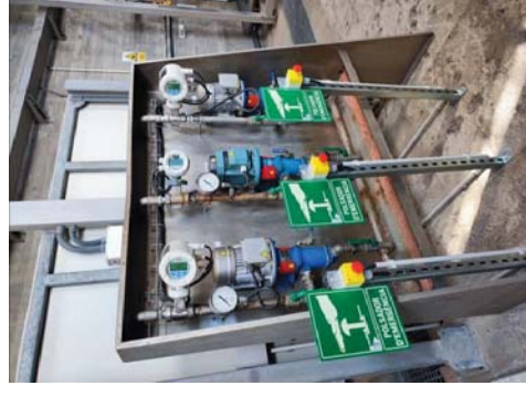
Figura 23.- Bombes existents de floculant
