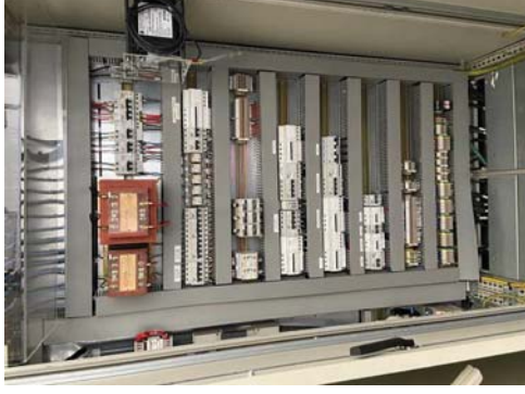
Figura 33.- Quadre de proteccions existent
