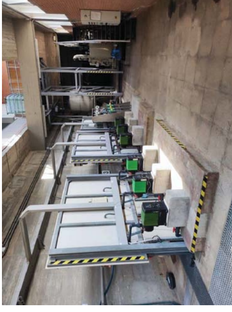
Figura 18. Bombes de dosificació de coagulant i floculant
