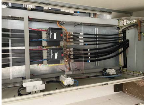
Figura 34.- Quadre de proteccions existent
