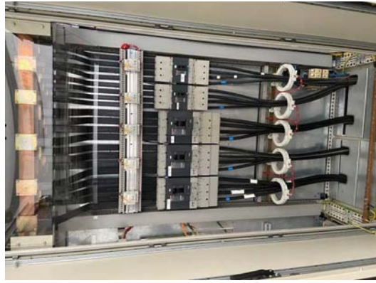
Figura 32.- Quadre de proteccions existent
