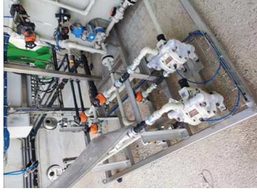
Figura 30.- Bombes dosificadores existents carbó en pols
