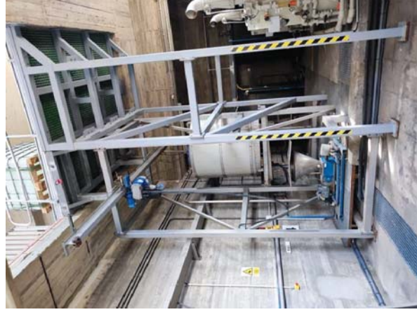
Figura 21. Instal·lacions de preparació de floculant
