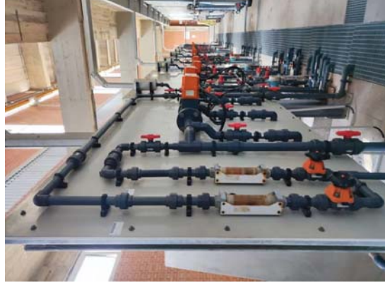
Figura 19. Valvuleria de les bombes de dosificació
