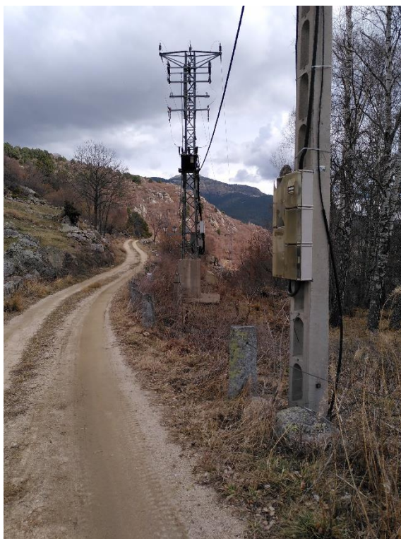
Figura 2: Vista general de la línia de mitja tensió de Cal Frare - camí de Viliella, i el PT.
