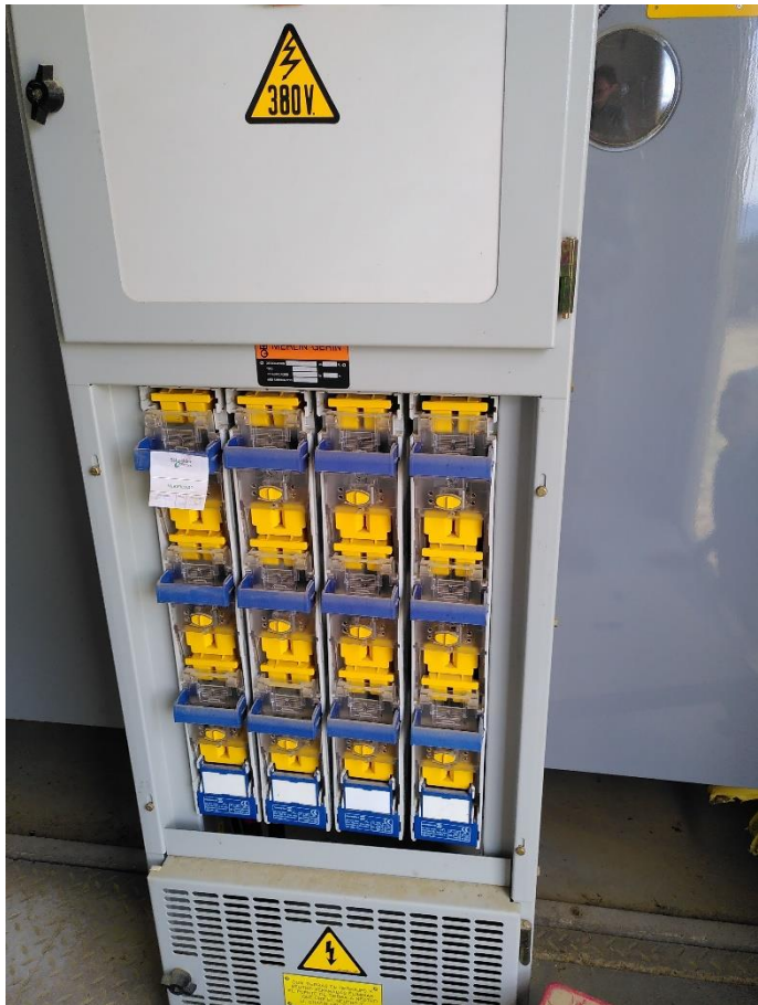
Figura 9: Armari amb porta-fusibles per a 4 sortides de baixa tensió.
