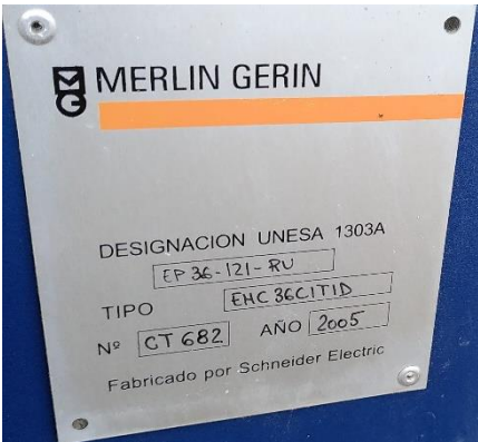
Figura 5: Placa de característiques de l'actual caseta CT.
