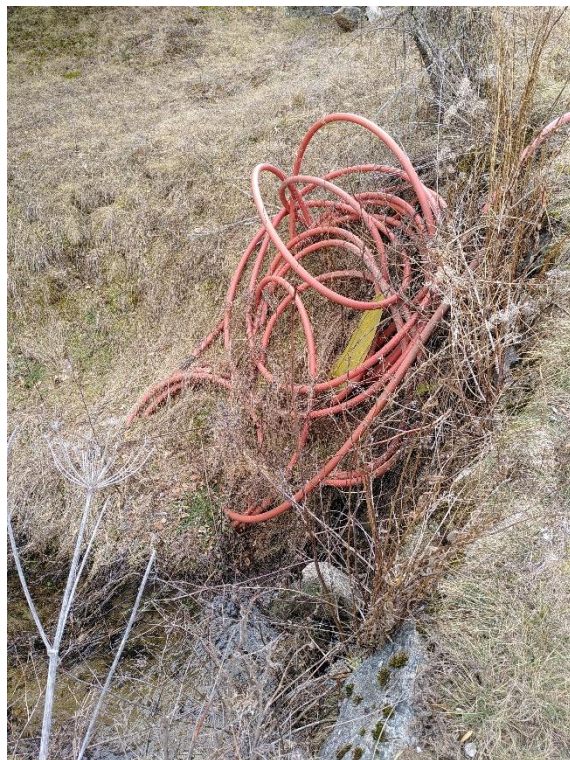
Figura 3: Cables de mitja tensió a la zona de Cal Frare - camí Vell de Viliella.
