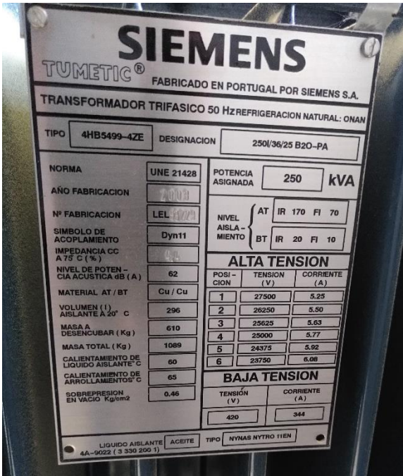
Figura 8: Placa de característiques del transformador existent.
