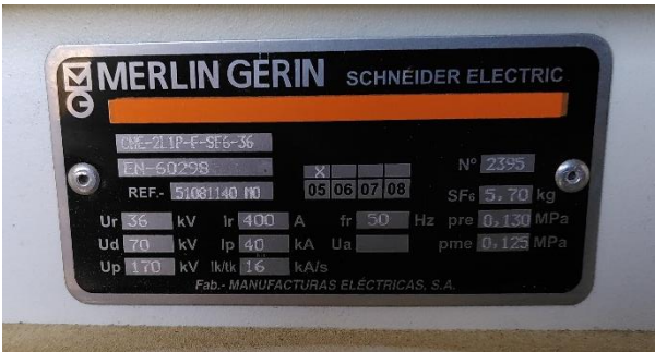
Figura 7: Placa de característiques de les cel·les compactes de les cabines de mitja tensió.
