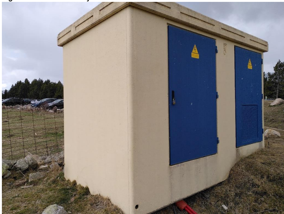
Figura 4: Vista general de la caseta CT de Cap del Rec
