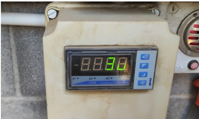
Imatge 1: Indicador de nivell del dipòsit de gasoil de l'escola Salvador Espriu.
