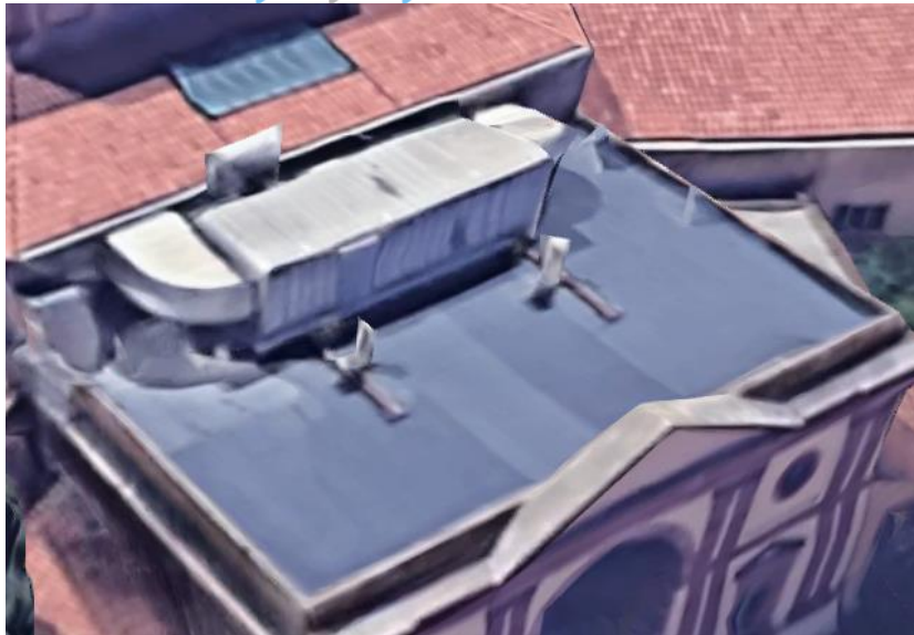
Climatitzador en Coberta Tècnica
