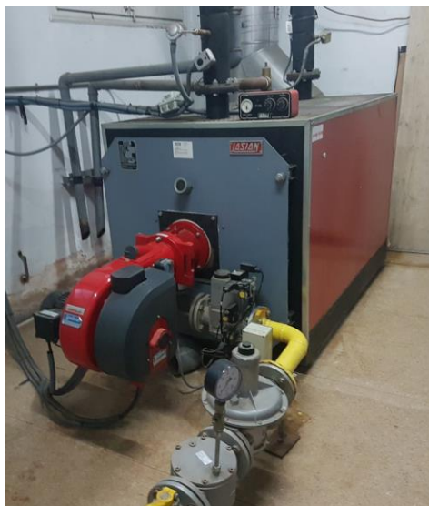
Caldera de 695 kW
