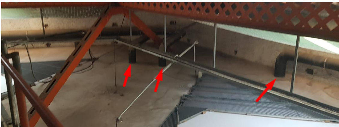
Imatge 1 – Conductes d'impulsió cap a Plenum
