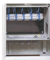
Espacio para conexiones
