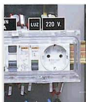
Toma de corriente
