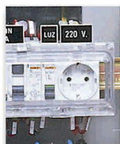
Toma de corriente
