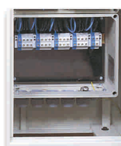
Espacio para conexiones
