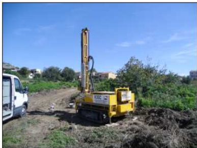
Foto-5: Vista parcial de la zona a edificar. Ubicació del sondeig S-2.
