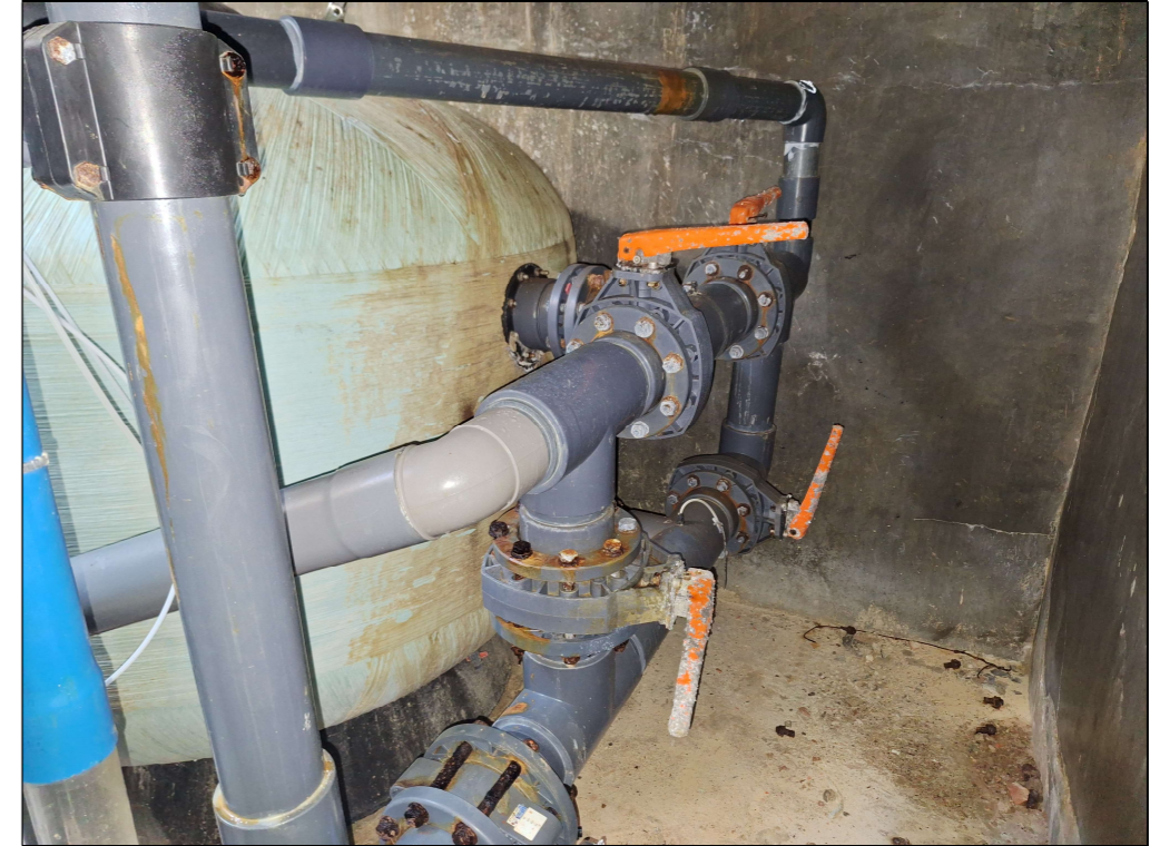
Figura núm. 9 Caseta d'instal·lacions. Estat actual instal·lacions
