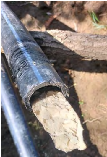
Figura 1: Acumulació de calç en la secció.
