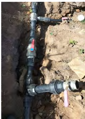
Figura 5 PK0+500 – Derivació amb comptador a la Rovira, vàlvula seccionament i desguàs
