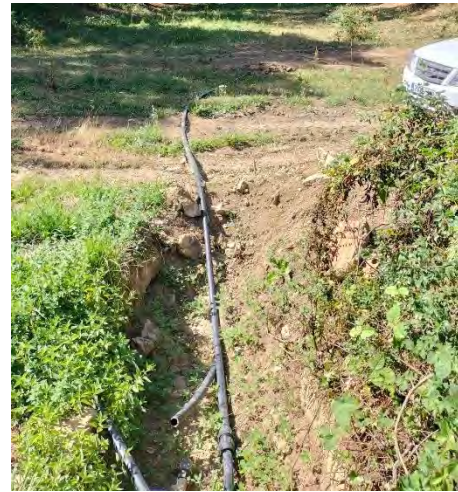
Figura 8 PK1+600 – Dipòsit trencament de càrrega Tremoledes
