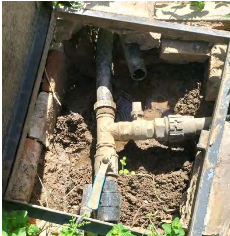
Figura 7 PK1+600 vàlvula seccionament i desguàs
