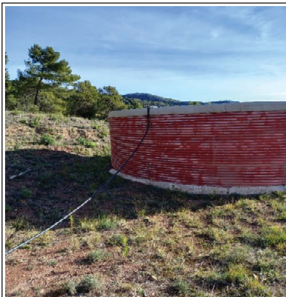
Figura 10. Estat punt d'aigua “La Bartra”
