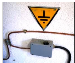
Connexió a terra
