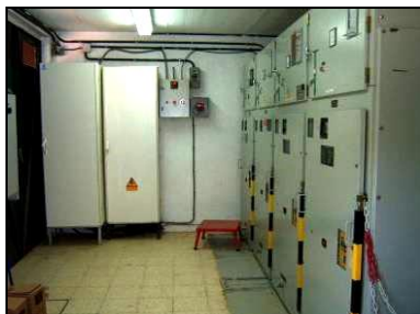
Sales de transformadors i quadres elèctrics
