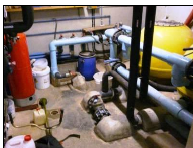
Sales d'instal·lació d'aigua
