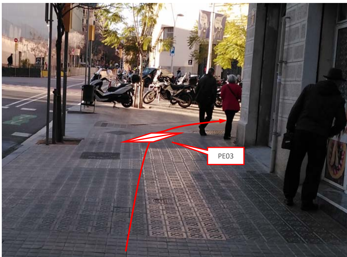
Nova canalització convencional de tipus 4c125 entre el pericó existent PE02 i el nou pericó PE03.
