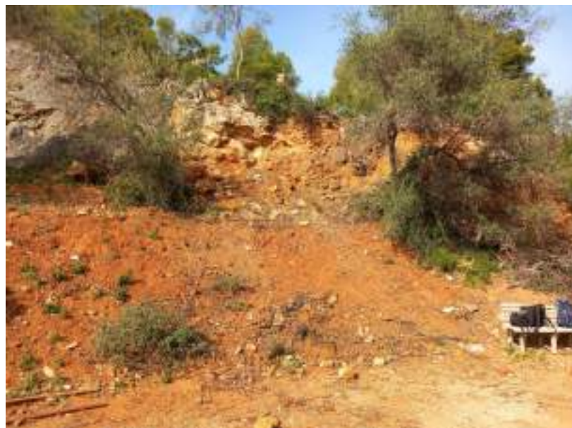
Figura 14. Massa rocallosa potencialment inestable al tram III
