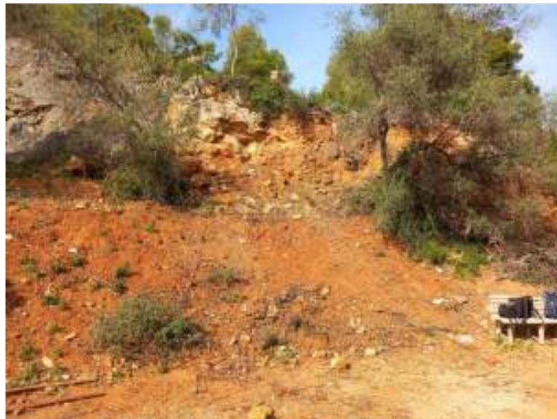
Figura 13. Massa rocallosa potencialment inestable al tram III
