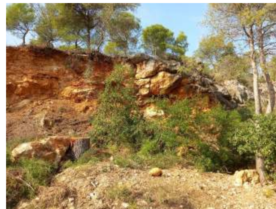
Figura 10. Massa rocallosa potencialment inestable al tram I
