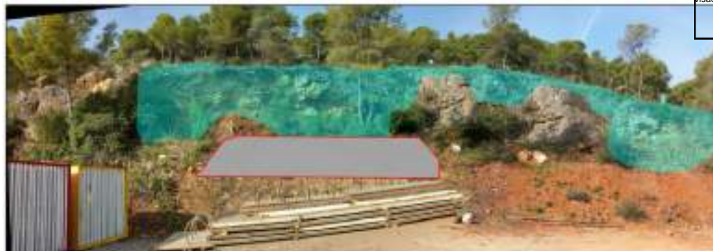
Figura 17. Vista general del cordó de terres temporal de seguretat a executar previ als treballs de purga
