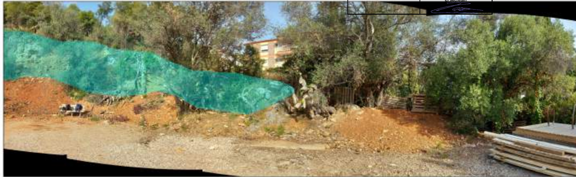
Figura 3. Delimitació de superfícies on cal un sanejament i purga intensiva del front del T01bis - Tram IV
