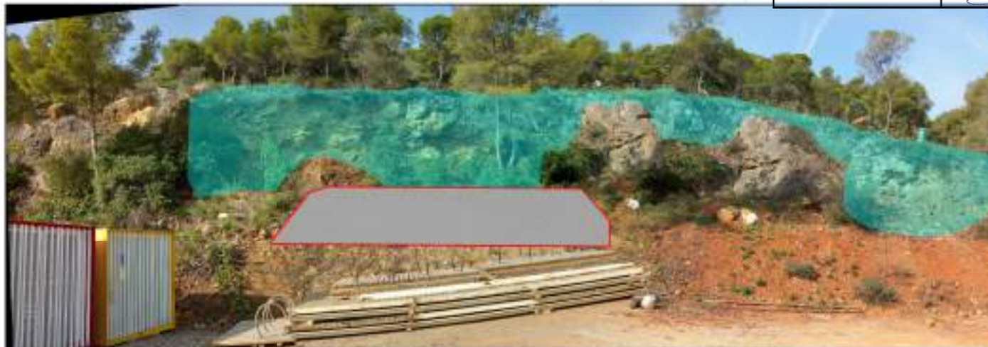
Figura 1. Delimitació de superfícies on cal un sanejament / purga intensiva del front del T01bis, Trams I i II / parcialment el III
