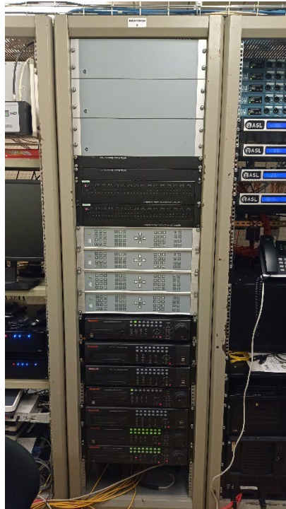
Rack de Matrius i gravadors analògics a Sala de comunicacions
