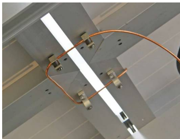
Imatge 4 .- Connexió a terra dels mòduls fotovoltaics i estructura metàl·lica
