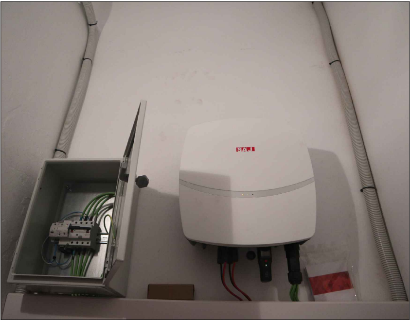
Imatge 1.- Inversor i quadre de la FV existent
