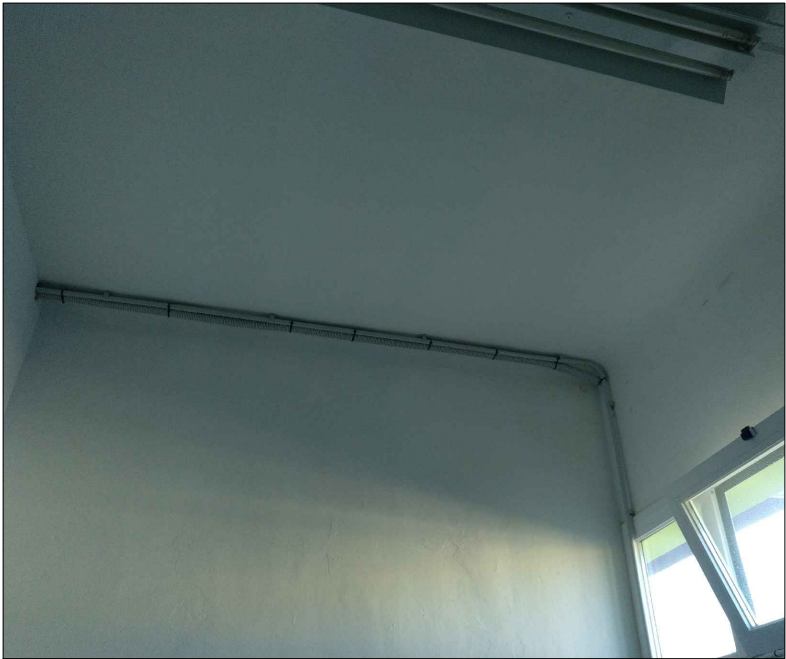
Imatge 2.- Entrada de cablejat CC de la FV existent
