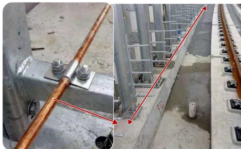
Figura 1 Línia de conductor de coure al llarg de la via ferroviària.
