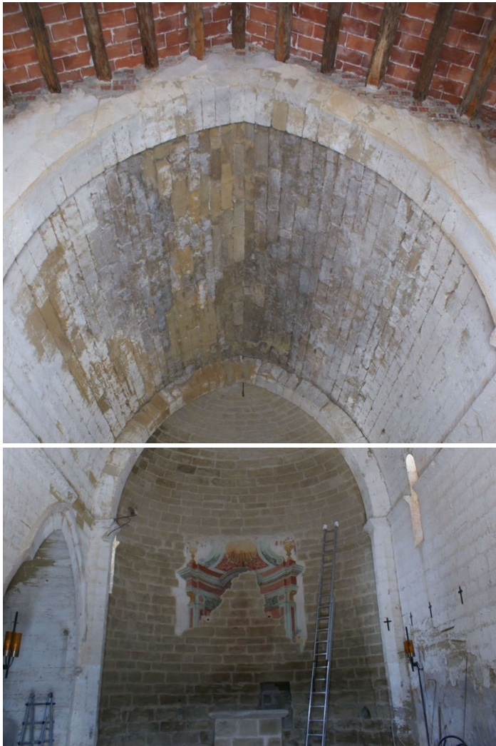
Vista de l'interior de l'ermita. L'àmbit restaurat de l'absis contrasta amb l'aspecte que ofereixen els paraments de l'interior i que posen en evidència el seu mal estat de conservació (foto: Ramon Solé).
