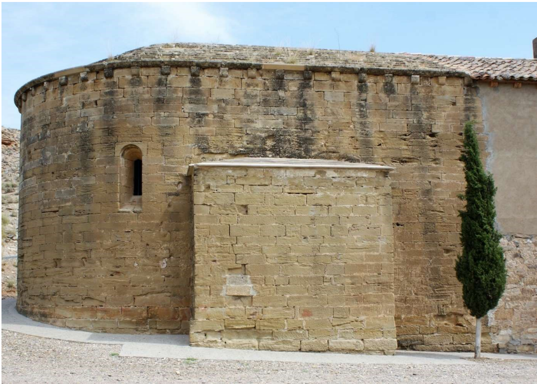
Façana orientada a ponent. S'observa a banda dels assentaments biològics, la gran quantitat de junts estructurals que romanen oberts per la desaparició del morter (foto: Ramon Solé).
