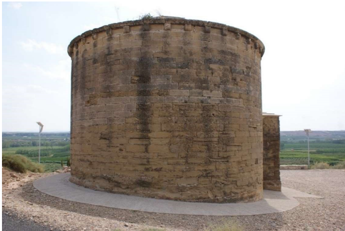
Vista de l'estat de conservació de l'absis exterior de l'església (foto: Ramon Solé)
