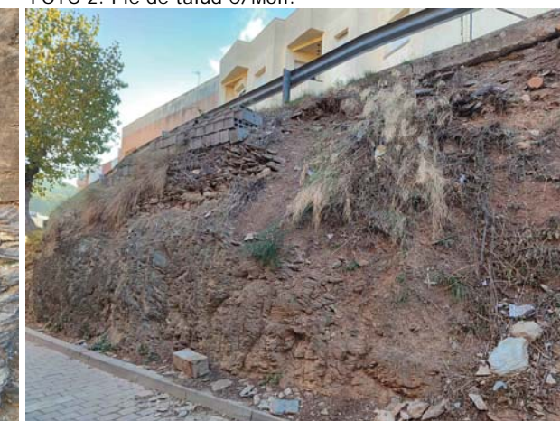
FOTO 4. Sector central con calzada descalzada en coronación.
