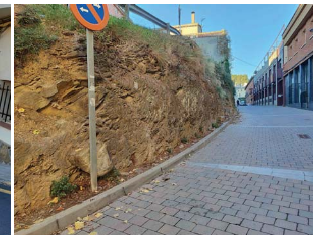
FOTO 2. Pie de talud C/Moll.
