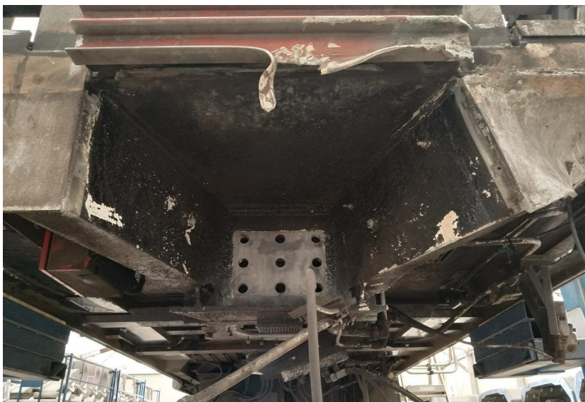
Figura 6: Placa d' enganxall, afectada
