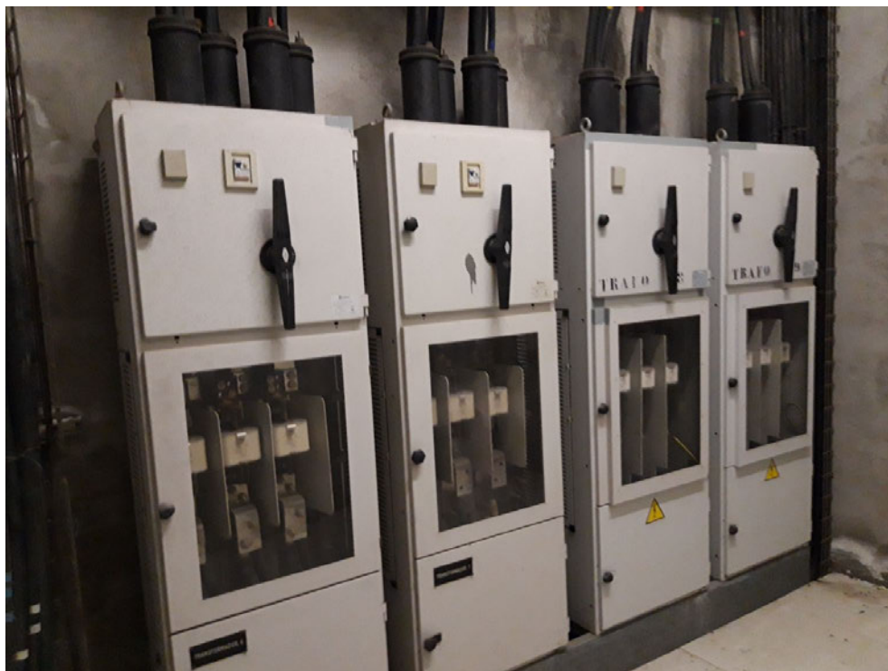
Fusibles de Baixa Tensió dels Transformadors 6, 7, 8 i 9 ubicats a l'edifici Roger de Llúria
