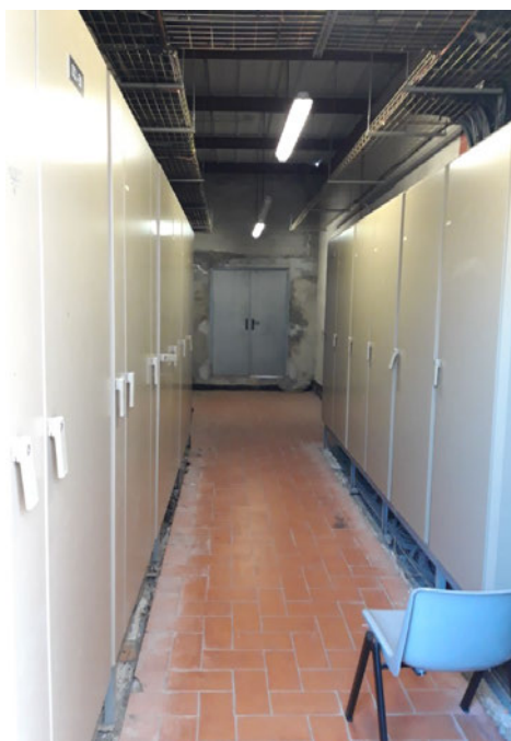
Sala de Quadres de Climatització.
