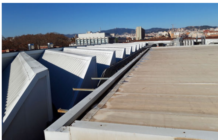
Vistes des del sostre de la Sala de Climatització.
