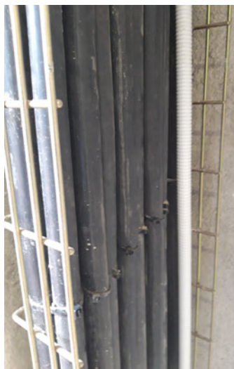
Cablejat d'alimentació al QG de Clima.
