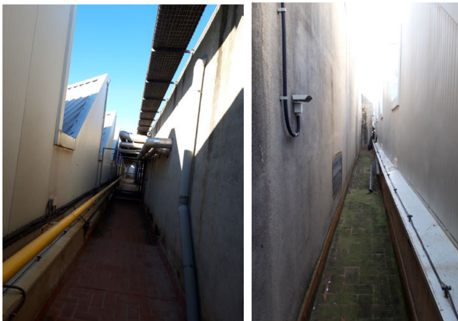
Zona de pas, entre la coberta amb dents de serra i la Sala de Climatització on s'hi ubiquen les màquines i quadres de Clima.
