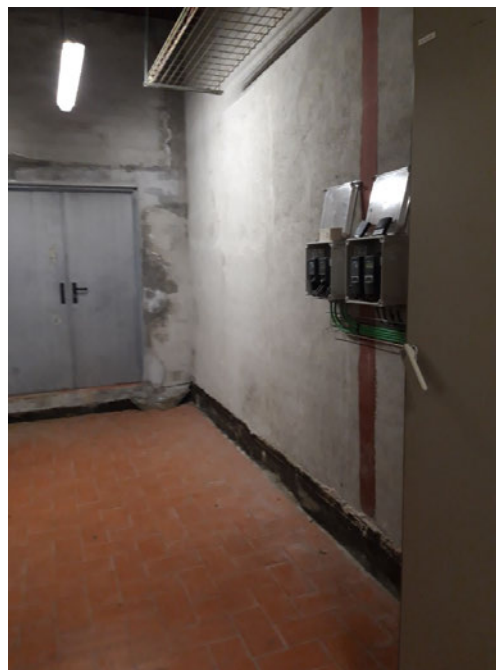
Espai per a la col·lació d'inversors de FV.
