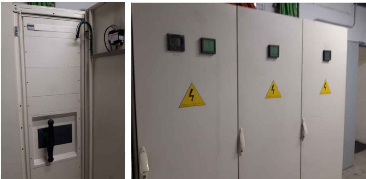
Proteccions i Quadres Generals dels Transformadors 3, 4 i 5 situats a l'edifici Jaume I.
