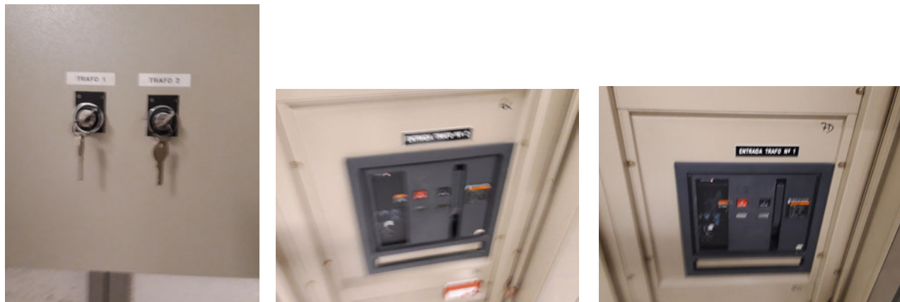
Proteccions Generals subministrats des dels transformadors 1 i 2, situats al'edifici Jaume I.
