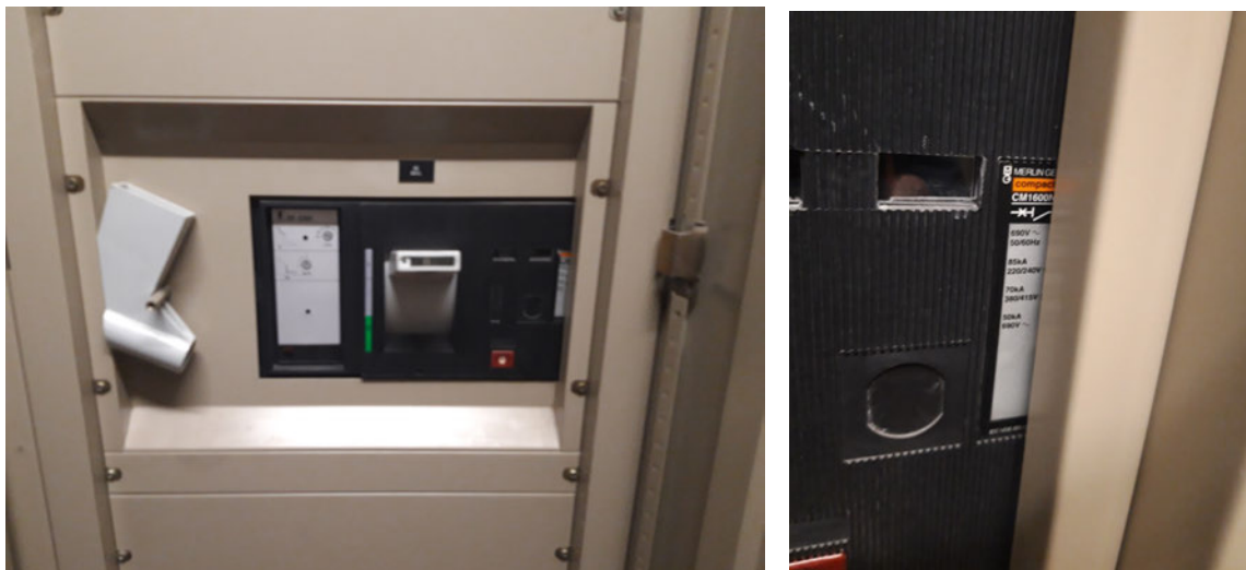
Protecció General del Quadre General de Clima, en Sala de Clima de Coberta.
