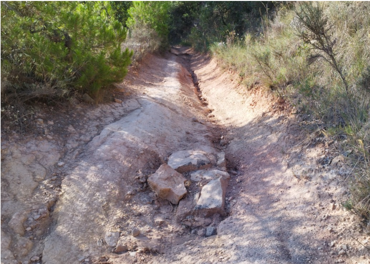
Figura 8: Tram on predominen les argiles i on s'ha creat un solc profund al camí.
