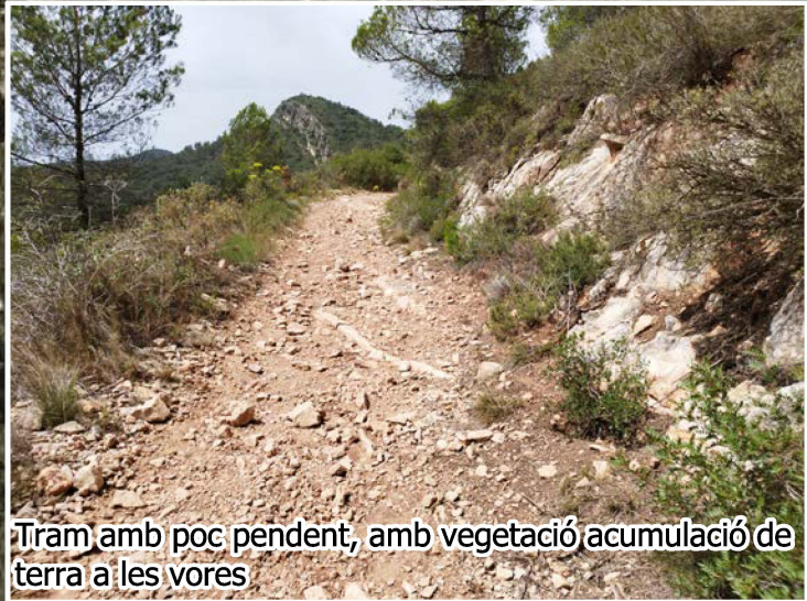
Tram que recull l'escorrentia de la part alta del camí
