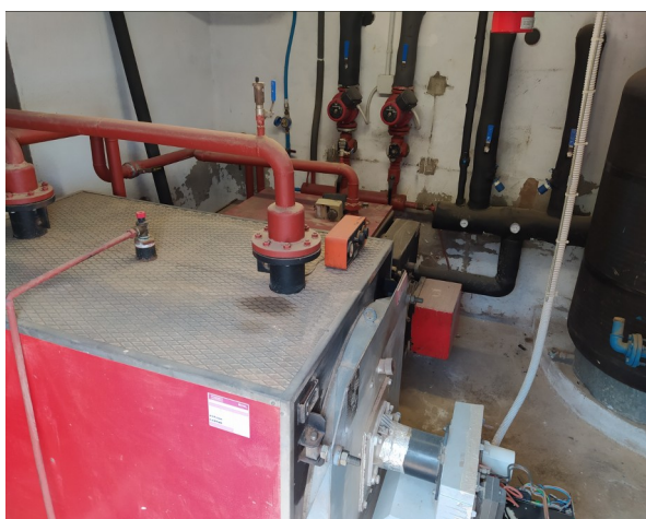
Figura 2: Sala de calderes
