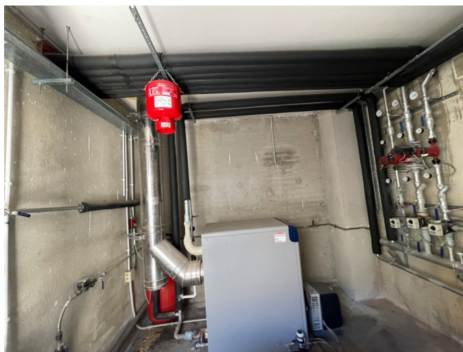
Figures 4 i 5: Caldera i sala de caldera
