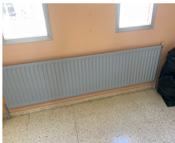
Figura 3: Radiador simple interior
