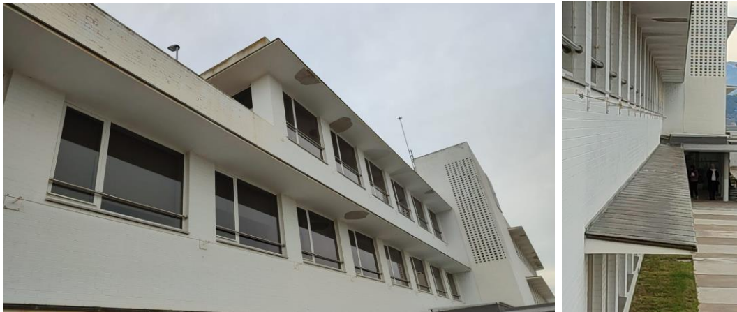
Detall de l'estat de l'arrebossat de les marquesines
