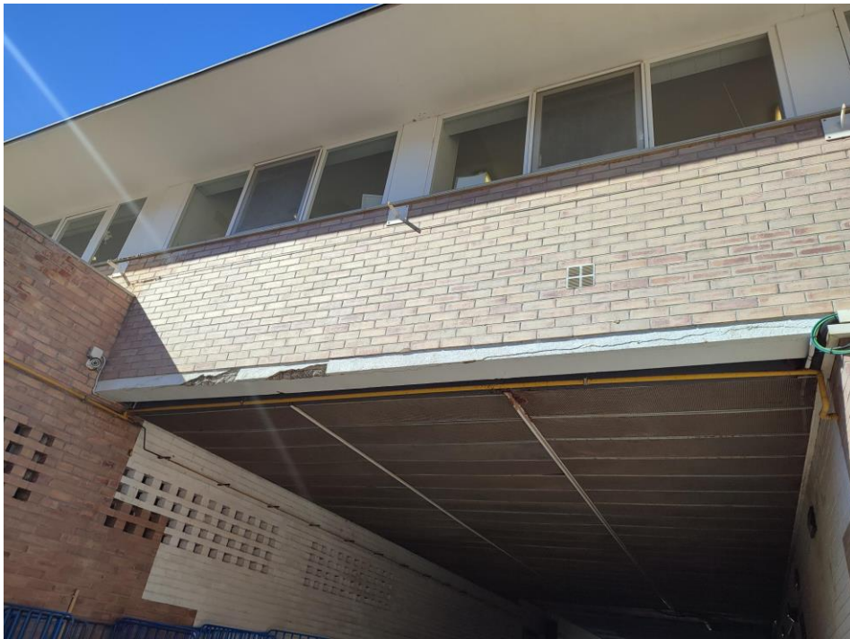
Dentell de la sortida del túnel d'accés a l'àrea del moll de càrrega i descàrrega de Bugaderia i Magatzem
