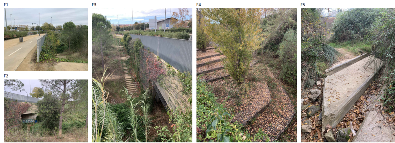
Figura 18 Estat actual de la riera de Sant Marçal al seu encreuament amb la BP-1413
