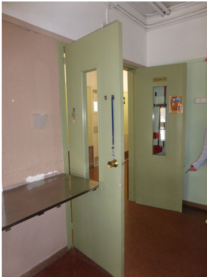
FIG. 2 - PORTA INTERIOR A INTERVENIR D'ACCÉS AL MENJADOR - PLANTA BAIXA (Edifici Antic - Primària)
