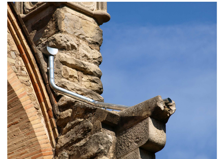
Detalls gàrgoles en mal estat
