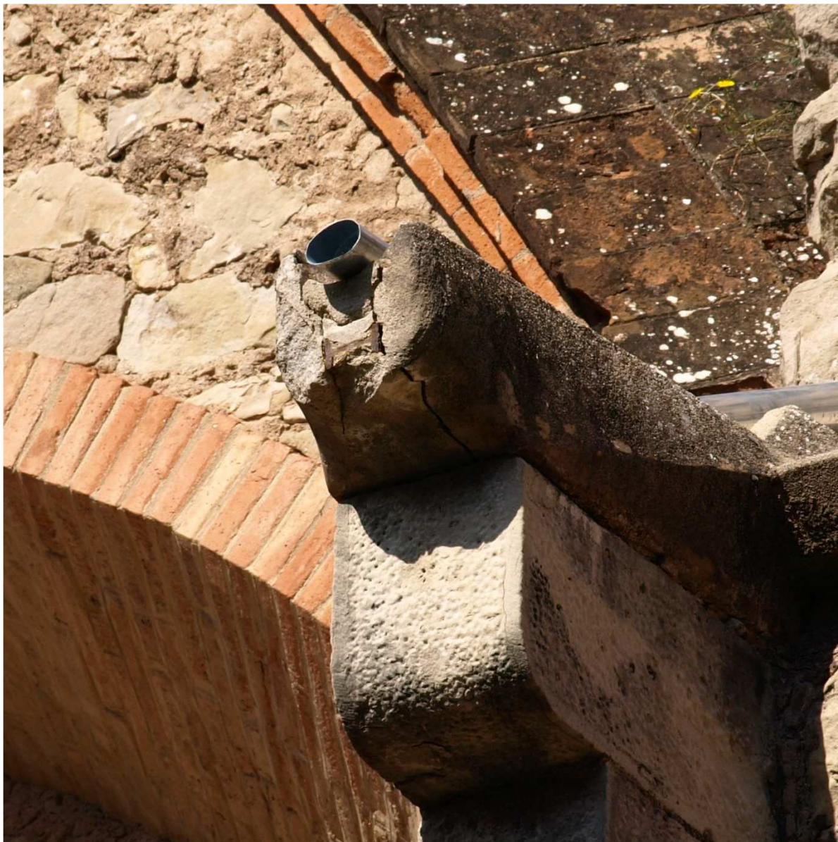
Imatge d'una de les gàrgoles de la teulada. Font: Santamaria Arquitectes
