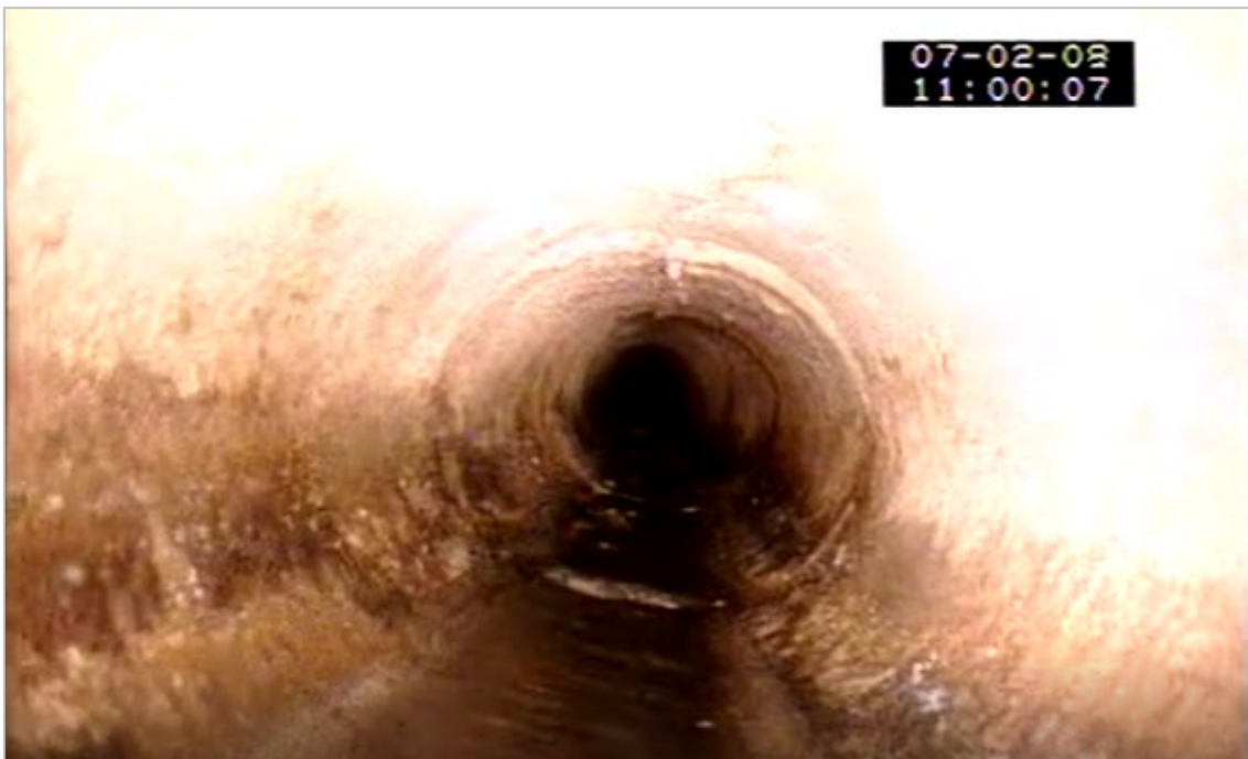
Figura 3. Deformació del tub
