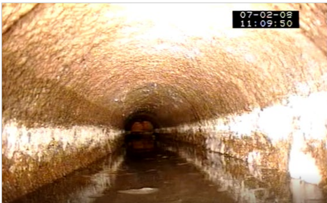
Figura 9. Acumulació d'aigua al final del tram
