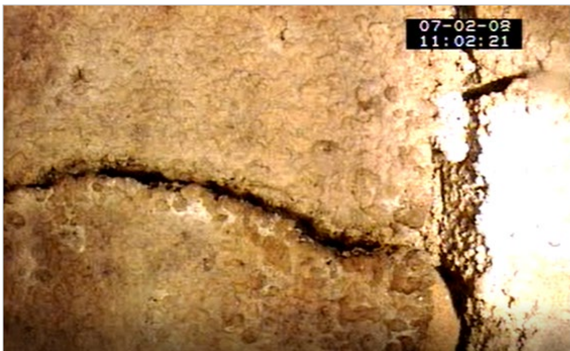
Figura 5. Fissura i junta oberta
