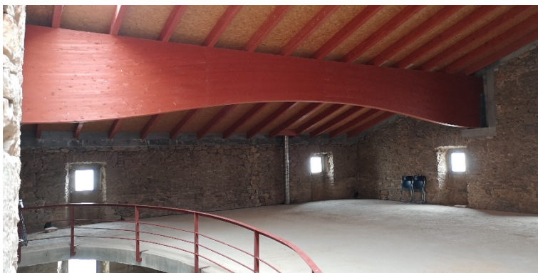
Prominents bigues de fusta laminades
