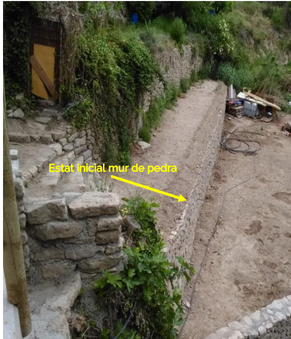
Figura 6. Estat inicial del mur delimitador del camí
