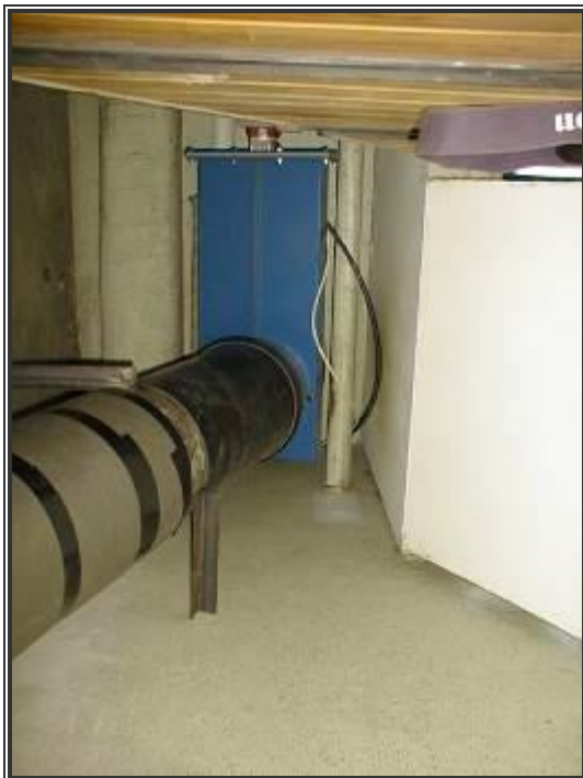
Válvula de seccionamiento vertical
