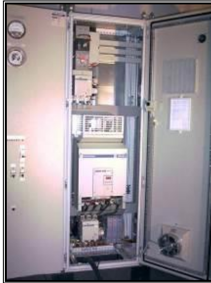
ECC centro elèctric de control
