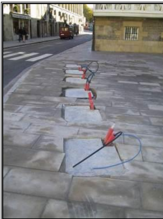
Conexionado buzones de vertido.
