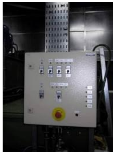
CB3 caja de control compactador-contenedor
