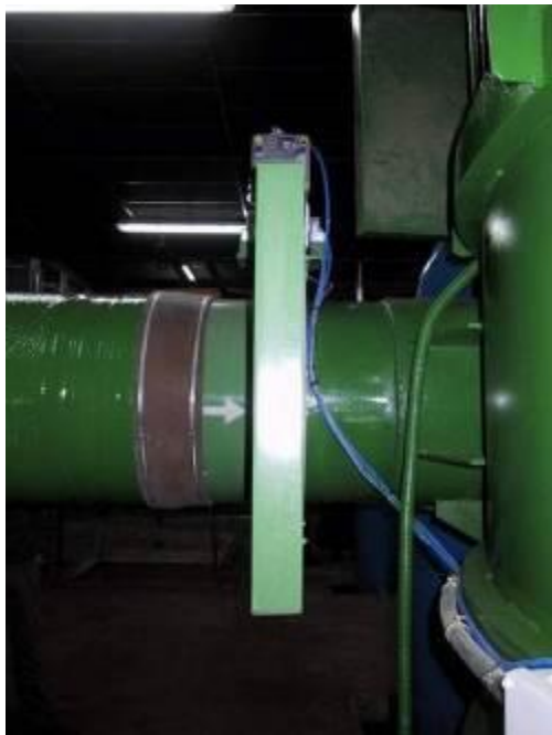
Vista lateral vàlvula de seccionamiento.
