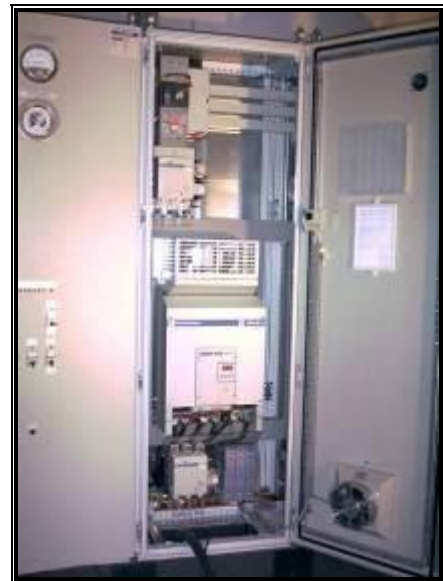
ECC centro eléctrico de control
