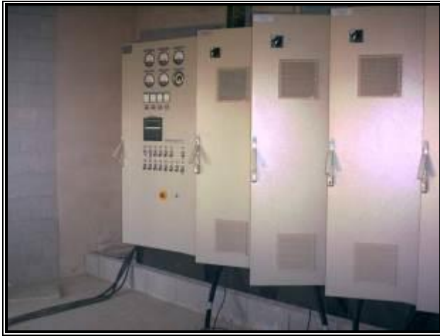
MCC Centro de control de motores
