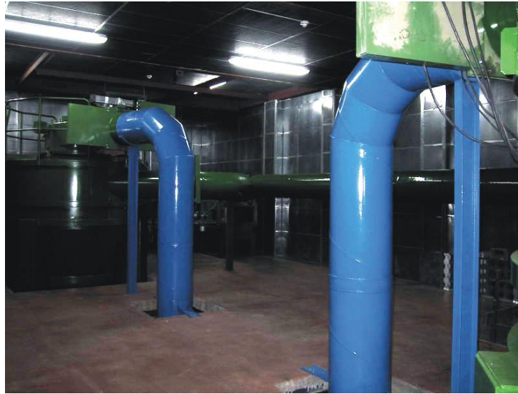
Ubicació vàlvula de seccionamiento.
