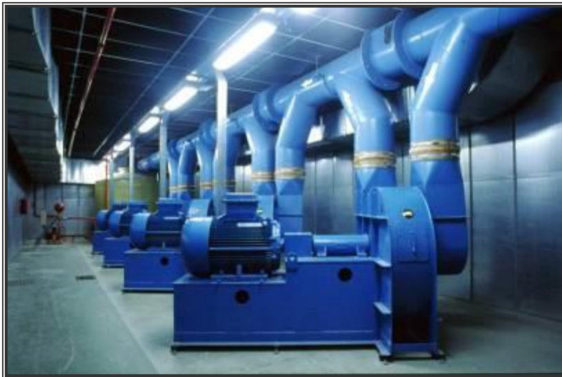
Vista general sala de turbos
