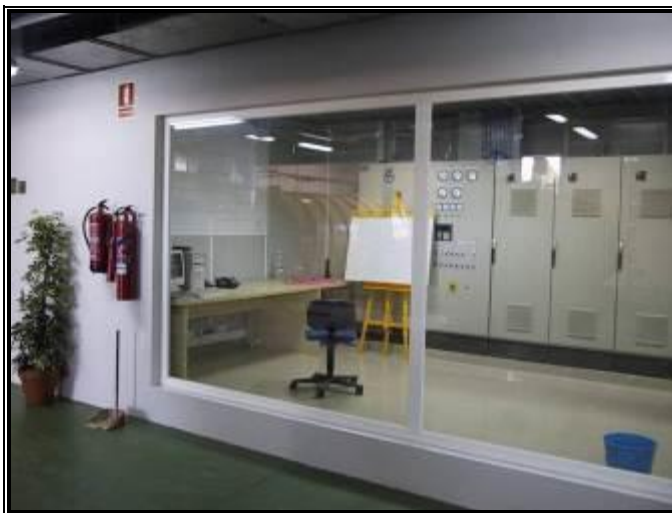
Sala de control
