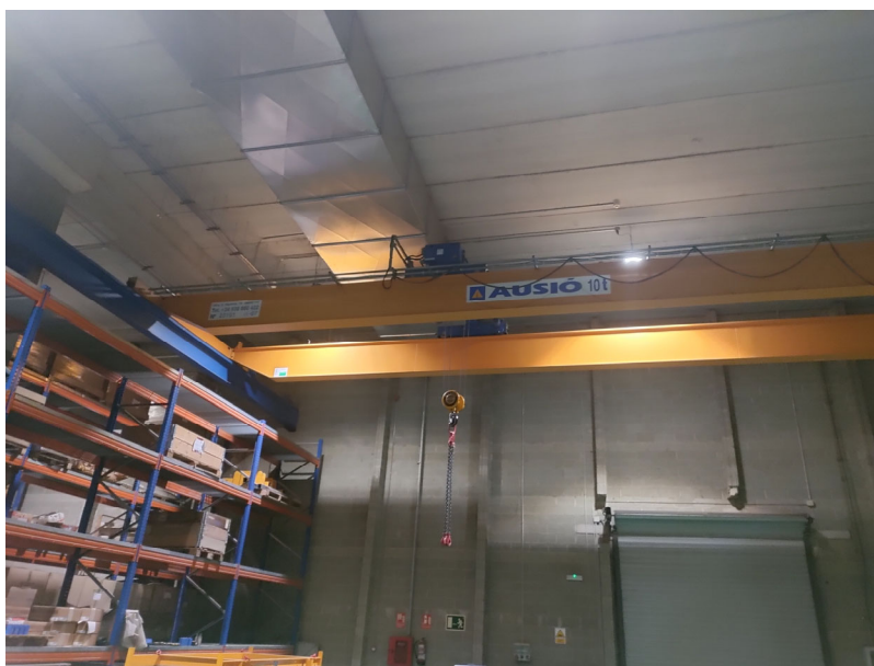
Imatge del pont grua existent
