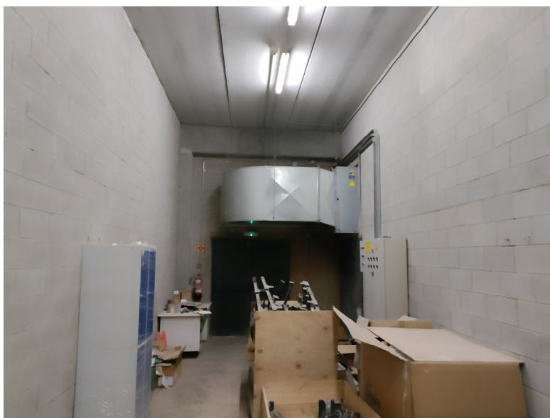
Imatge sala elèctrica ventilació
